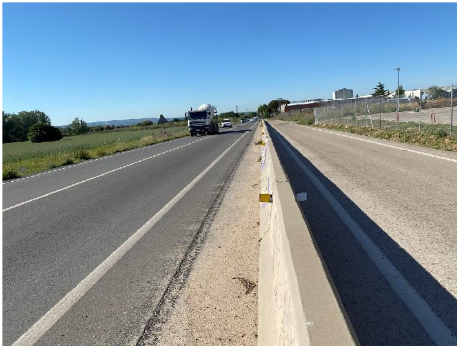
Imagen del estado actual de la vía de servicio existente y el tronco principal de la Ctra. M-119
