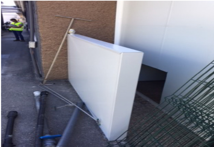
Figura 16. Salida de aire climatizador con paneles de protección acústica.
