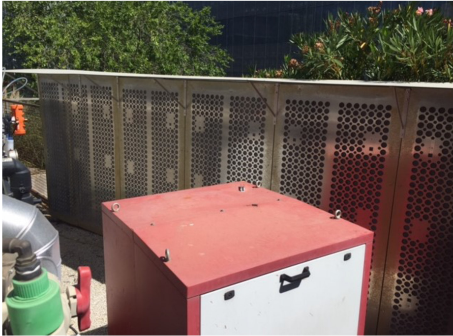
Figura 15. Instalación soplante con paneles de protección acústica.
