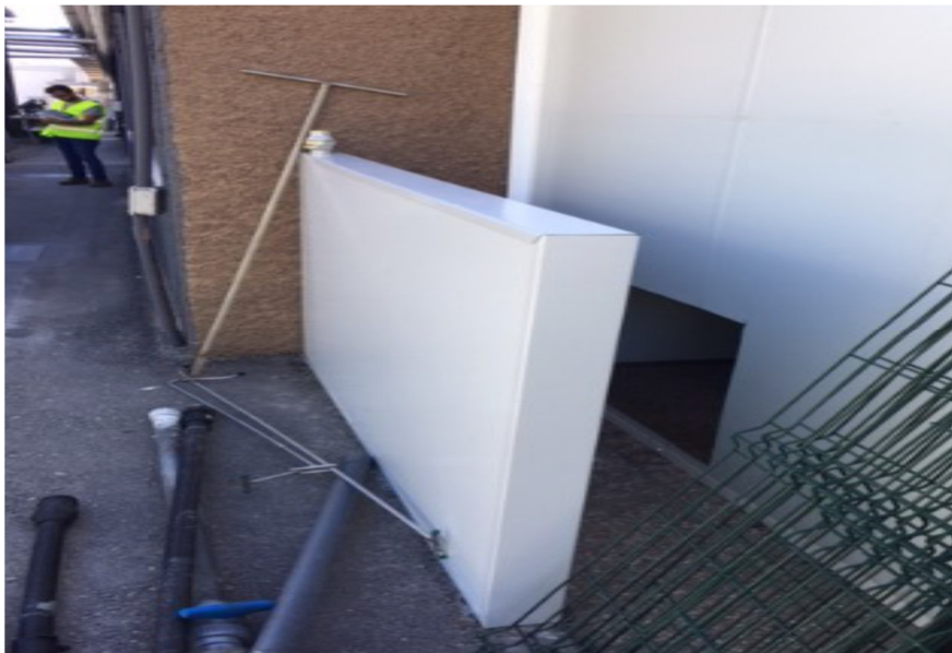
Figura 19. Salida de aire climatizador con paneles de protección acústica.
