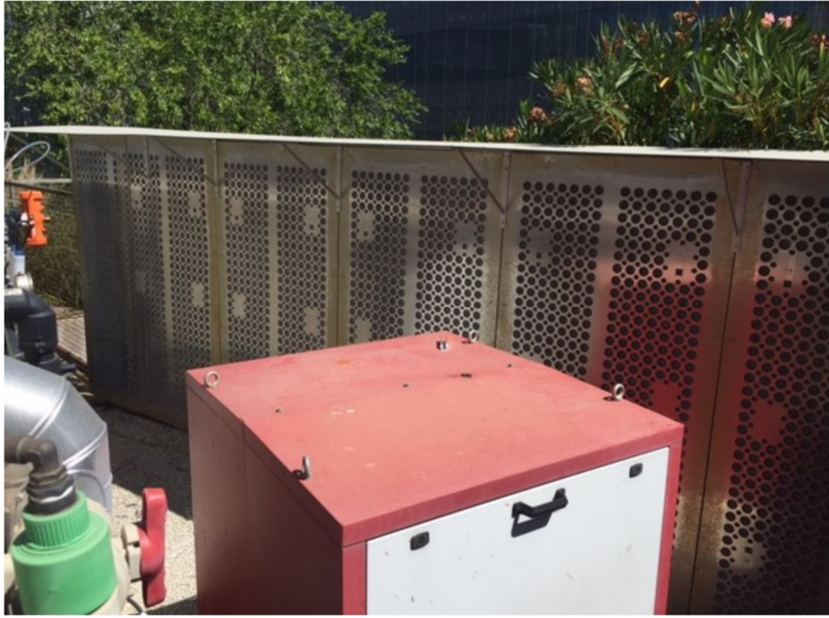
Figura 18. Instalación soplante con paneles de protección acústica.
