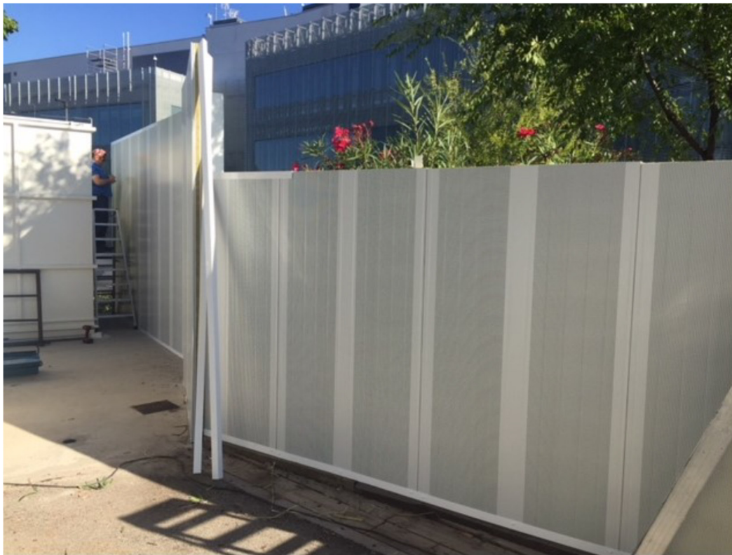
Figura 17. Zona Este de instalaciones con paneles de protección acústica.
