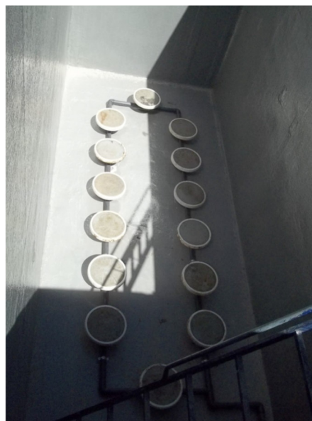
Figura 12. Foto del interior de la balsa de pretratamiento (membranas de aireación).
