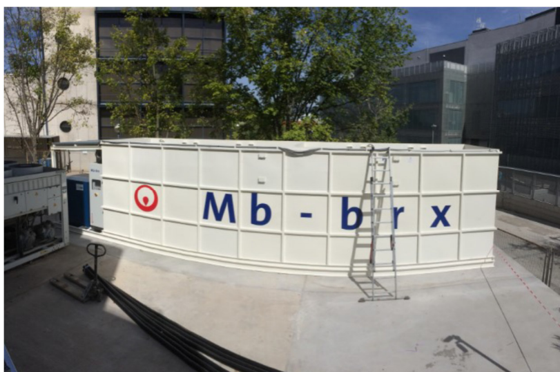
Figura 14. Imagen del biorreactor MBBR, depuración biológica de vertidos.
