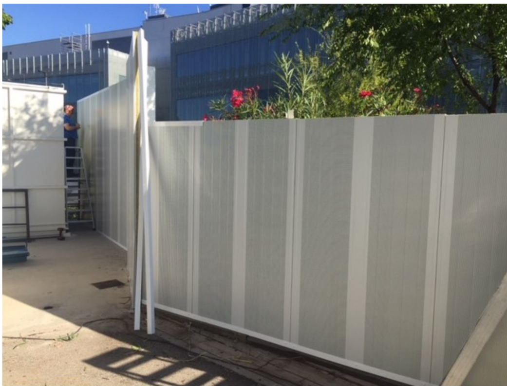
Figura 20. Zona Este de instalaciones con paneles de protección acústica.
