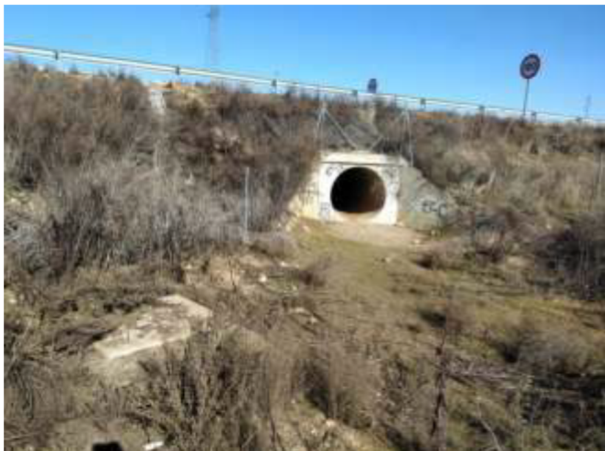
Vista áqueta Telefónica tras el cruce de la R-2
