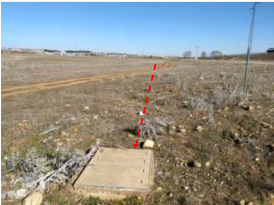
Vista del recorrido desde la arqueta seta en gasoducto hacia arqueta Telefónica.
