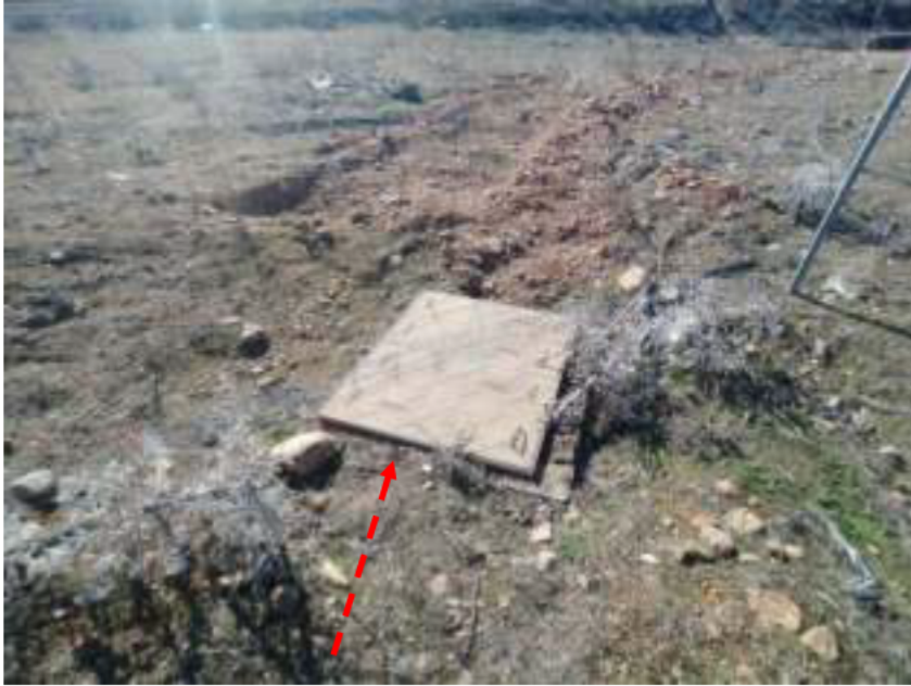
Vista arqueta telefónica bajo el vallado de la R-2
