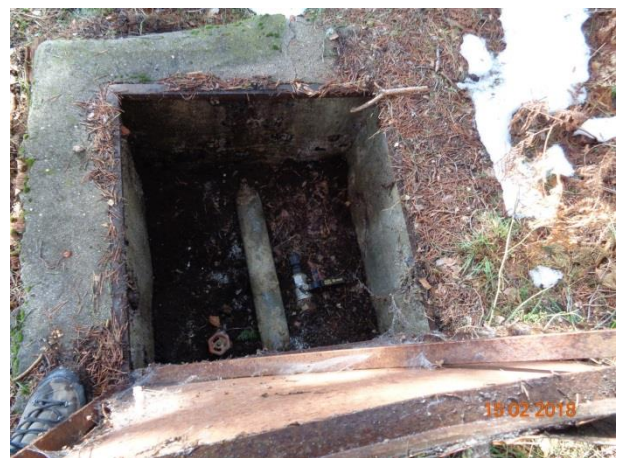
Ilustración 10 - Estado actual del sistema de arquetas y llaves de conexionado a los depósitos a reacondicionar
