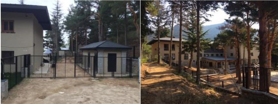
Ilustración 13 - Centro de Transformación y Generación auxiliar y camino compactado dónde se enterrará la línea de media tensión y se dará paso a vehículos de servicio y mantenimiento de la torre de alta tensión ubicado al final.
