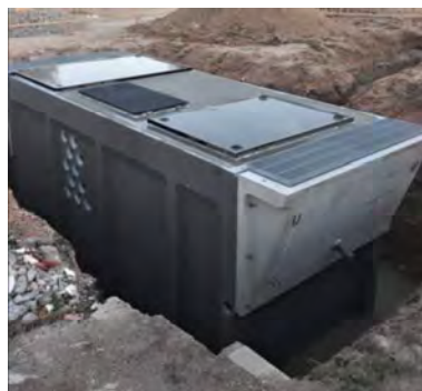
Imagen 11. Centro de seccionamiento tipo
