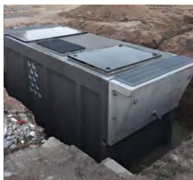
Imagen 11. Centro de seccionamiento tipo
