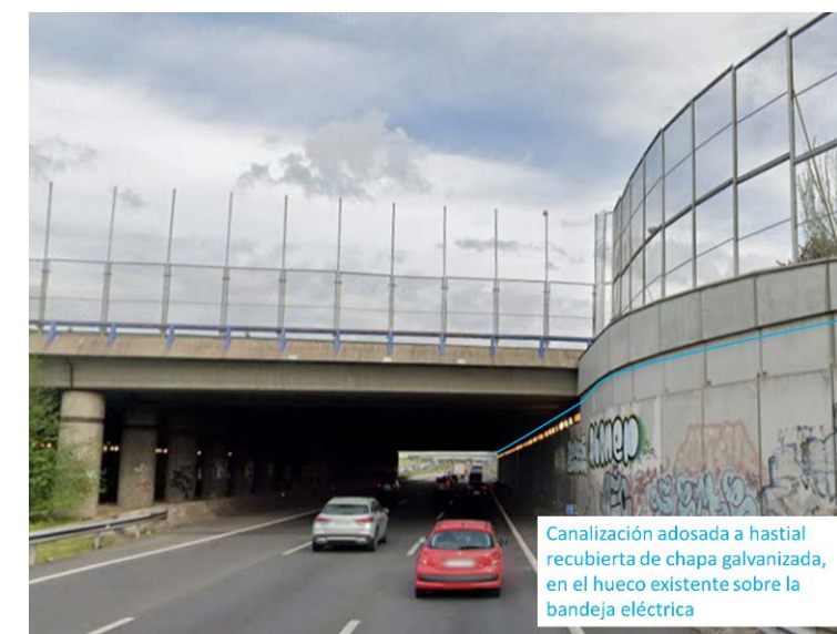
Figura 12: Canalización adosada a hastial de paso inferior bajo A-5, PK 32+300
