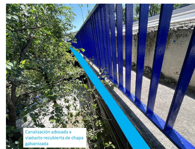
Figura 3: Canalización en la margen derecha a 50 cm del cerramiento, junto a EDAR La China en PK 21+750
