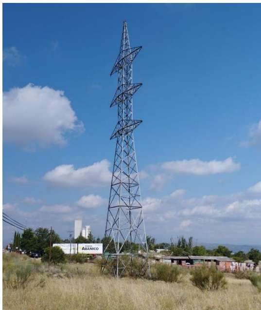
Figura 40. Torre de alta tensión en el interior del ámbito de estudio.
