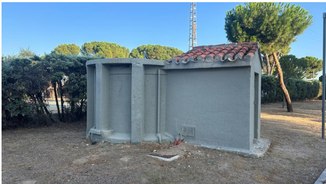
Figura 23. Caseta destinada al sistema de riego
