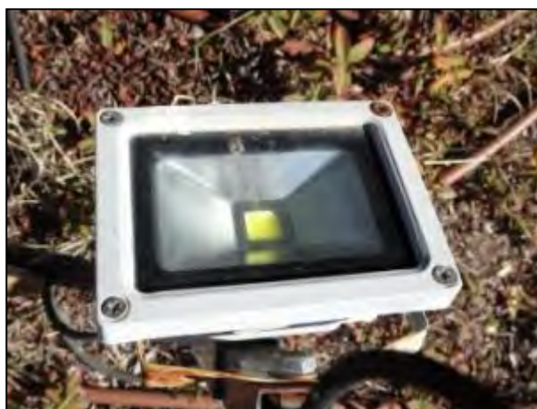
Imagen 94. Punto de luz elevado, proyector de led, sobre un árbol seco.
