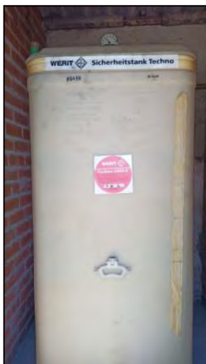
Imagen 42. Depósito de gasoil del Cuarto técnico 2
