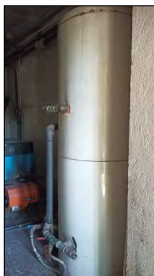
Imagen 21. Depósito de agua caliente sanitaria del edificio principal.
