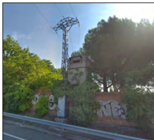
Imagen 7. Entrada de la línea eléctrica al transformador eléctrico de la finca. (Fuente de la imagen, Google Street View)
