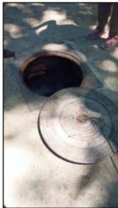
Imagen 34. Tapa de acceso al depósito de gasoil enterrado, ubicado junto al cuarto técnico del edificio principal
