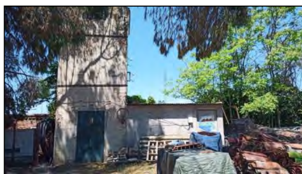
Imagen 9. Torre del transformador el Cuarto técnico 1 adosado.
