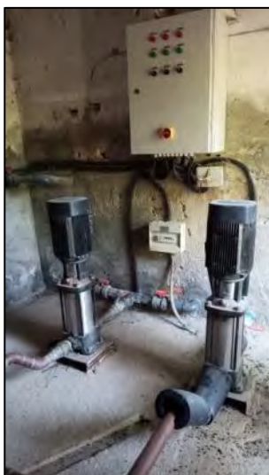
Imagen 17. Grupo de bombeo general.
