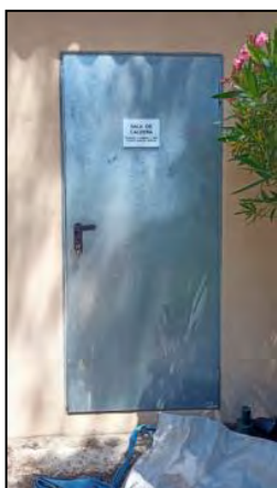
Imagen 38. Acceso al cuarto de la caldera en el Cuarto técnico 2.
