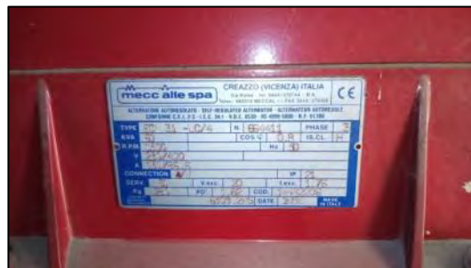
Imagen 11. Chapa de características técnicas del grupo electrógeno.
