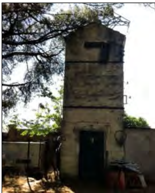
Imagen 8. Torre de Iberdrola con el transformador eléctrico. La imagen está tomada desde el interior de la finca.
