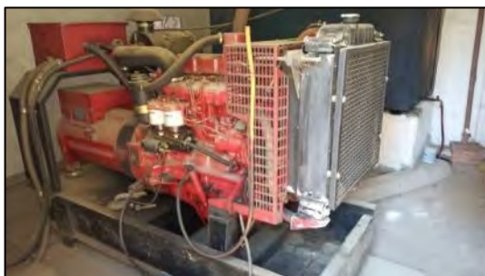
Imagen 10. Grupo electrógeno de emergencia.
