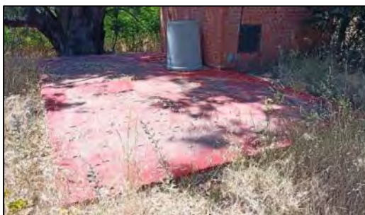
Imagen 15. Superficie del depósito general de agua potable, y cuarto técnico del grupo de bombeo.
