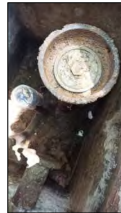
Imagen 35. Punto de carga del depósito de gasoil enterrado, ubicado junto al cuarto técnico del edificio principal
