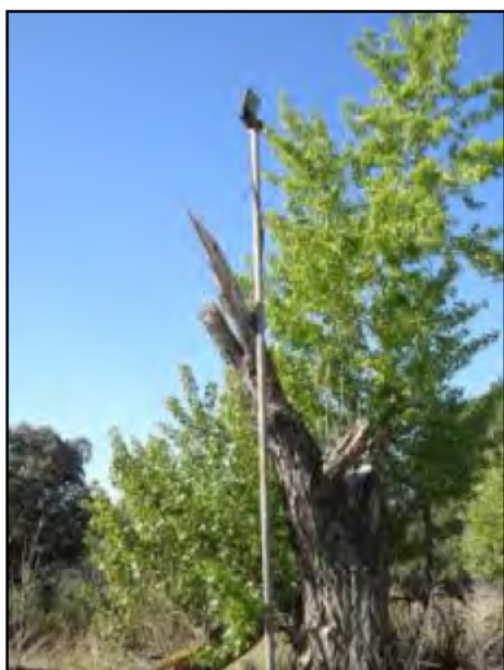
Imagen 85. Punto de luz elevado sobre un poste. Proyector de leds,
