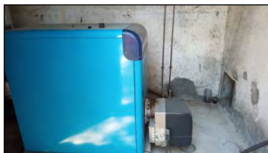
Imagen 39. Caldera en el Cuarto técnico 2.
