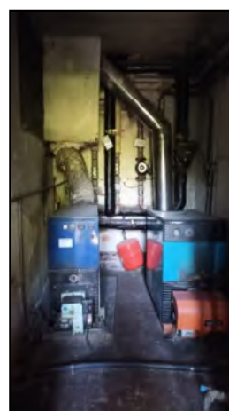
Imagen 31. Calderas del sistema de calefacción del edificio principal (salvo el salón invernadero)
