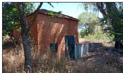
Imagen 16. Cuarto técnico del grupo de bombeo, y depósito general.
