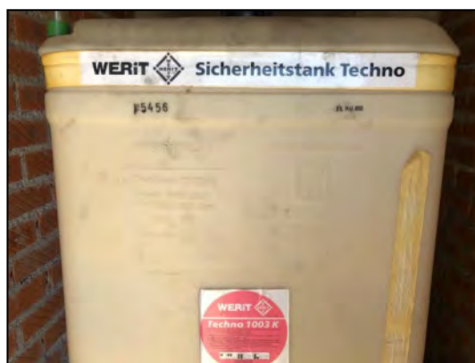
Imagen 43. Detalle del depósito de gasoil
