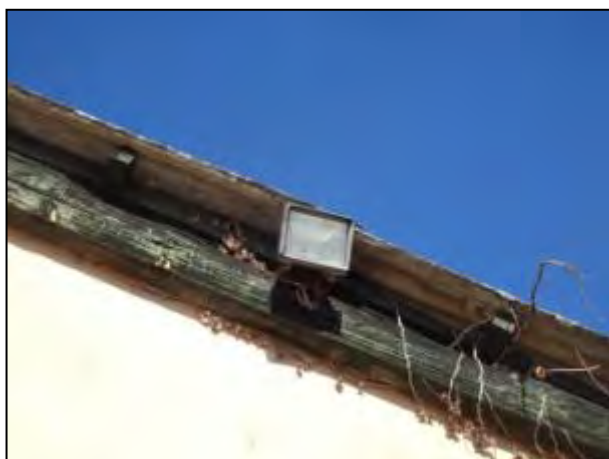
Imagen 87. Punto de luz elevado, sobre un edificio. Proyector halógeno.
