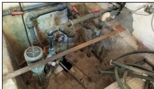
Imagen 27. Interior del Cuarto técnico 3, con el grupo de bombeo que distribuye el agua a la red de riego, y el depósito enterrado
