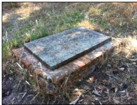
Imagen 23. Arqueta del pozo
