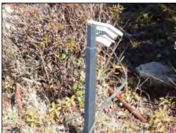
Imagen 93. Punto de luz elevado, proyector de led, sobre un árbol seco.
