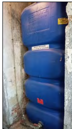
Imagen 20. Depósito de agua potable del edificio principal.
