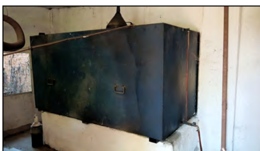
Imagen 12. Depósito de gasoil del Cuarto técnico 1, para alimentación del grupo electrógeno de emergencia.
