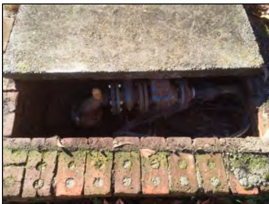
Imagen 24. Arqueta abierta, con la tubería de extracción
