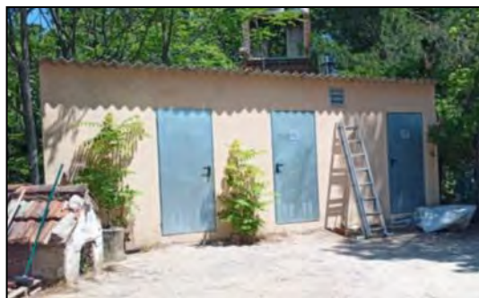
Imagen 36. Cuarto técnico 2, ubicado entre la torre del transformador y la vivienda de guardeses.
