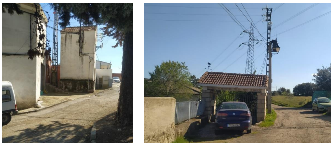
Figura 121. Centros de transformación eléctrica.
