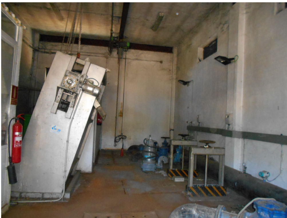
Estado interior de la EBAR actual, objeto de acciones ajenas perjudiciales para su funcionamiento.
