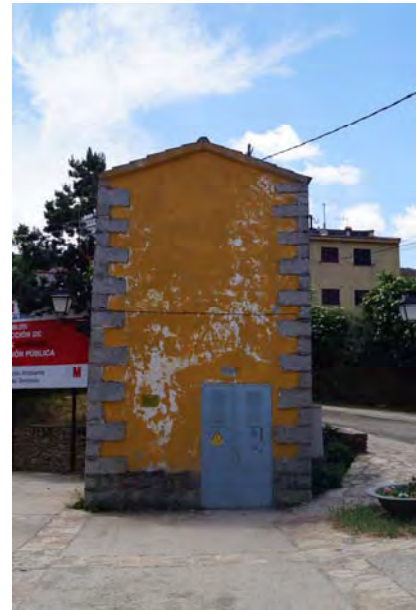
Figura 3.1.2.3.- Acometida eléctrica. Conexión a centro de transformación municipal (Fuente: Elaboración propia)
