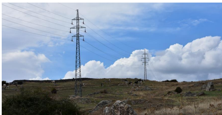
Figura 4. Línea eléctrica de media tensión.
