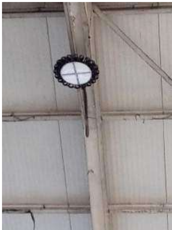
Detalle de la instalación de luminarias LED de la instalación de Pinto.
