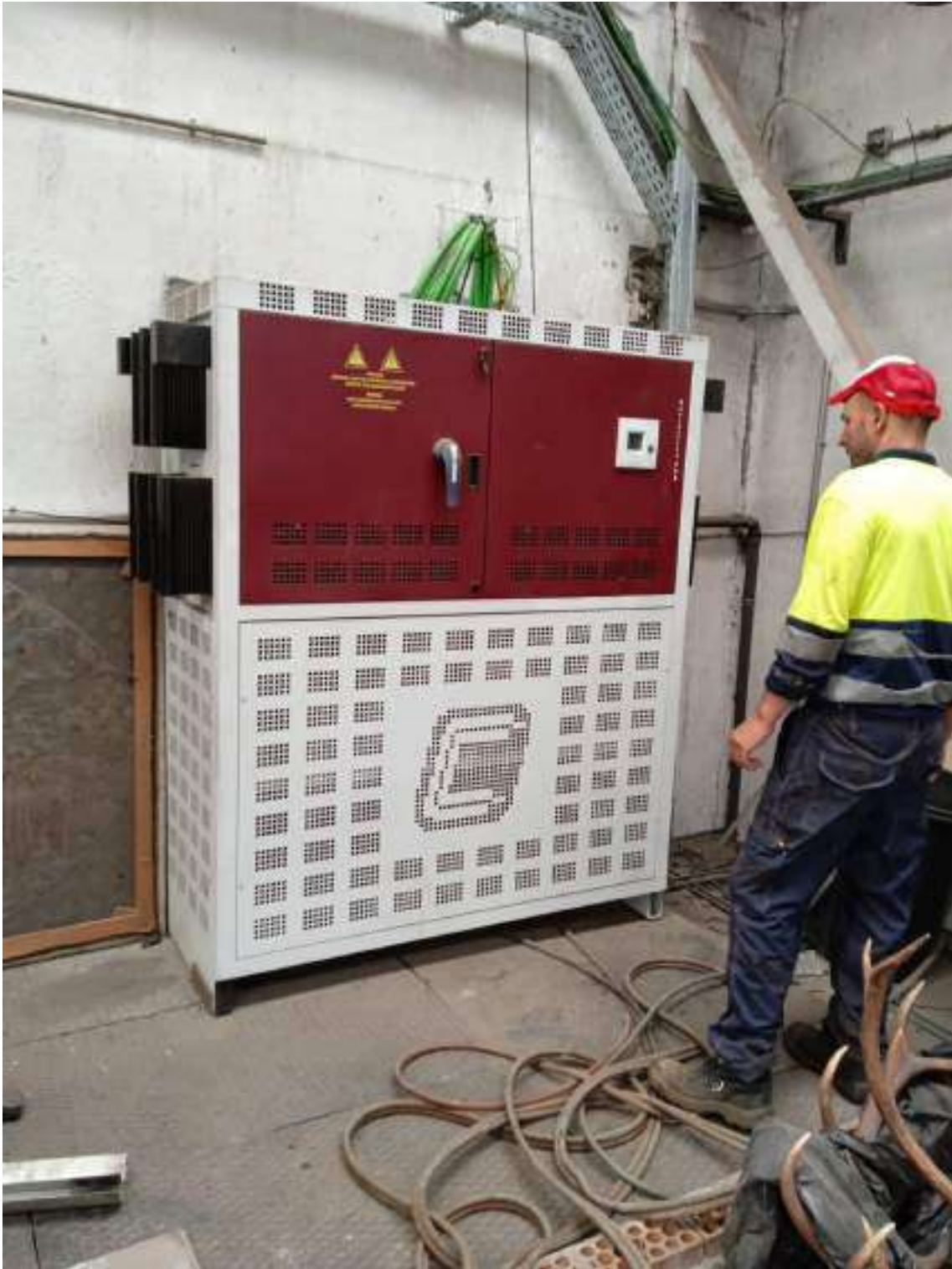
Detalle del armario que contiene la batería de condensadores de la instalación de Pinto.
