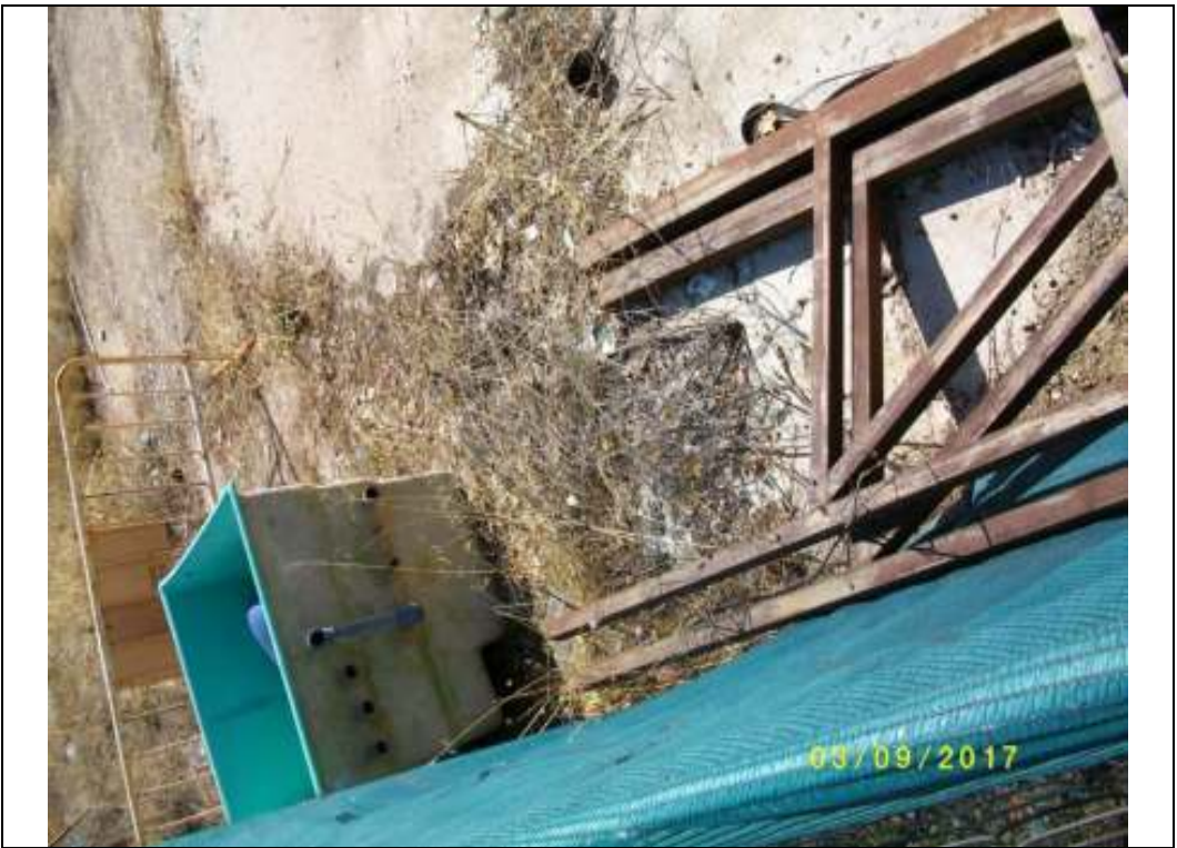
Fotografía nº 39: detalle de arenero de poliéster vacío
