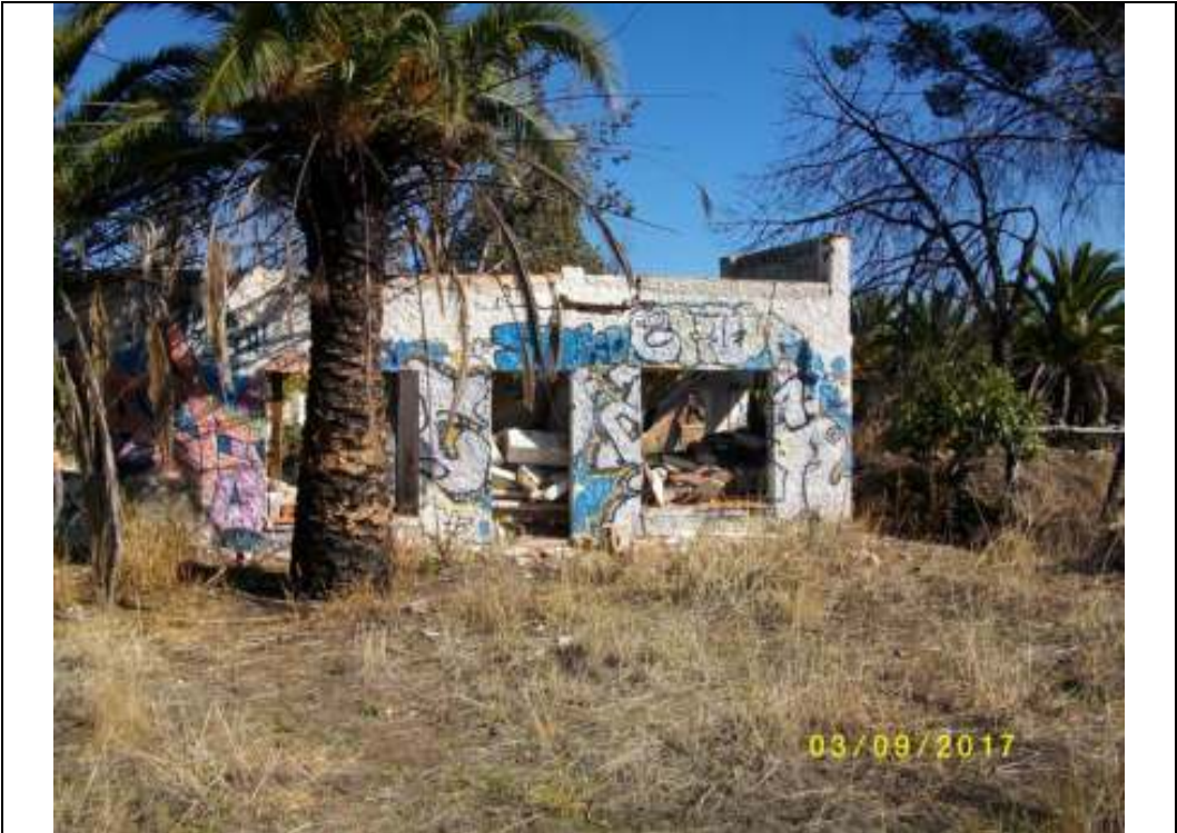
Fotografía nº 91 (Parcela B): edificación en ruinas con restos de la cubierta demolida en interior
