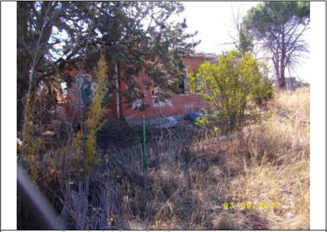
Fotografía nº 12 (Parcela B): edificación parcialmente derruida
