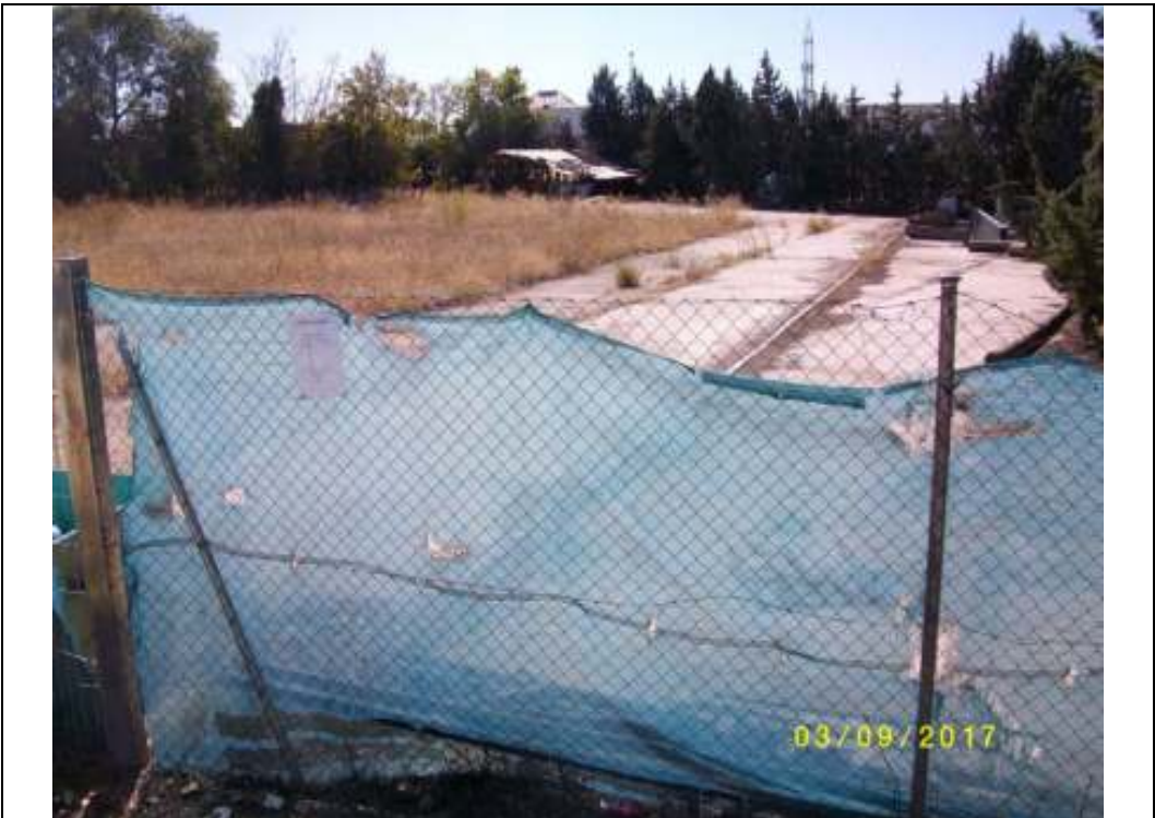
Fotografía nº 14 (Parcela C): solera de hormigón y edificación auxiliar en ruinas
