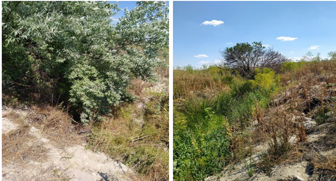
Foto arroyo Santiago, visible ausencia trabajos de conservación. 9 junio de 2021
