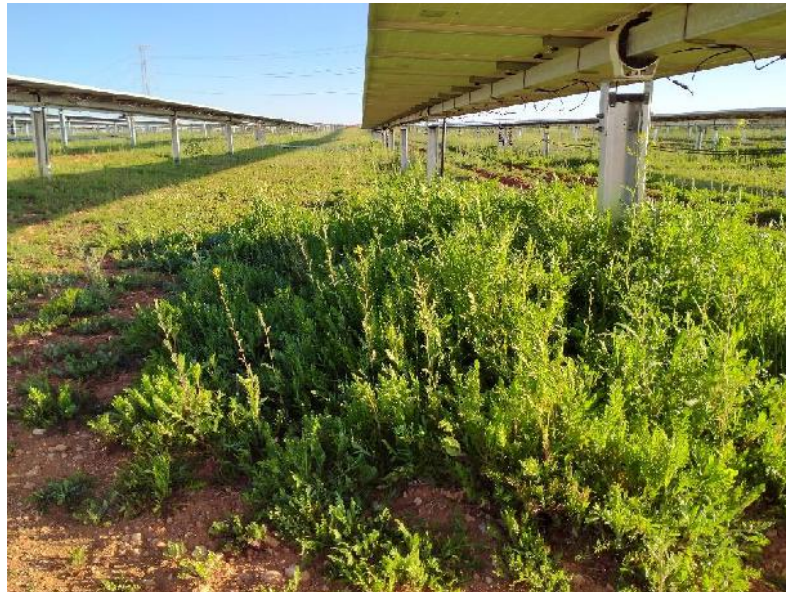
Imagen 12.3.1.a. PSF de 50 MWp Olmedilla (Cuenca). (2021). Fuente: Iberdrola Renovables.
