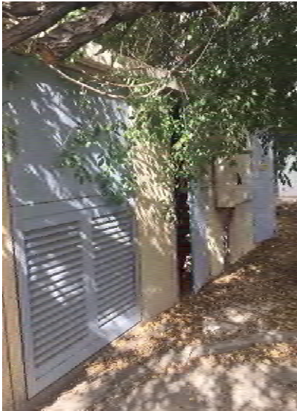
Centro de transformación en esquina noroeste de la parcela.
