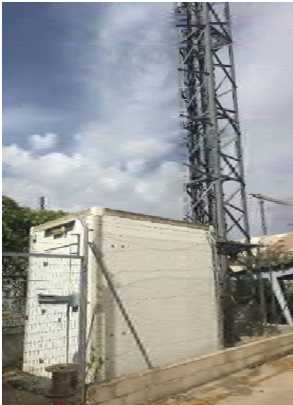
Caseta y antena de telecomunicaciones.
