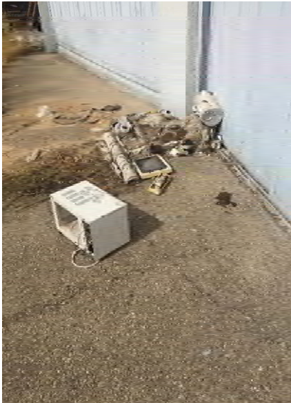
Diferentes residuos que muestran el estado de la parcela resultado de la falta de mantenimiento
