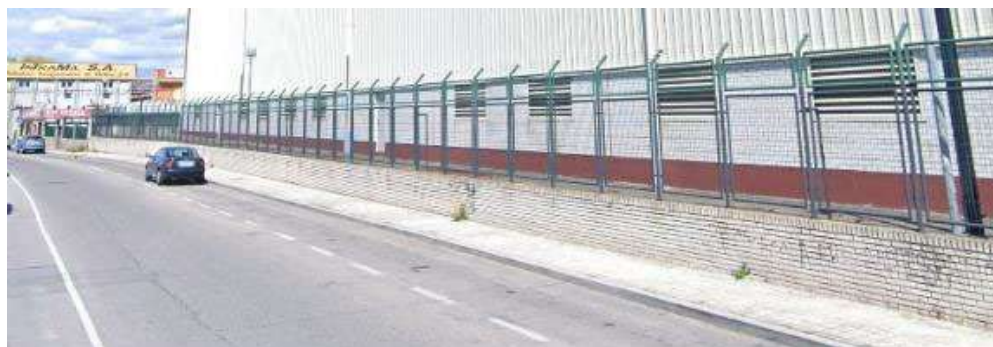
Figura 44. Estado actual de la acera de calle Sauce
