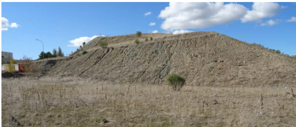
Vista general de la zona oriental del talud T5, próximo a la planta de Sepiolita. No parece detectarse inestabilidad del talud, aunque sí se han identificado regueros como consecuencia de la pobre cubierta vegetal.
