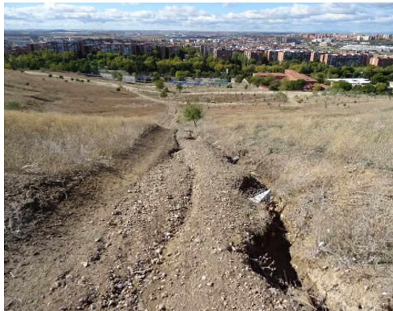
Vista de la mitad inferior de la cárcava de C4.
