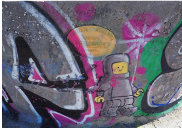
Fig. 35 Detalle del estado del vértice geodésico del Cerro de Almodóvar
