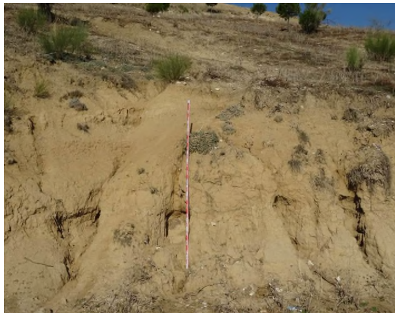
Detalle del talud T3 en el que se aparecen evidencias de erosión remontante debido a la composición arenosa de los niveles geológicos donde se ha generado. Se observa también la escasa cubierta vegetal en la cabeza del talud que evitaría dicha erosión remontante.
