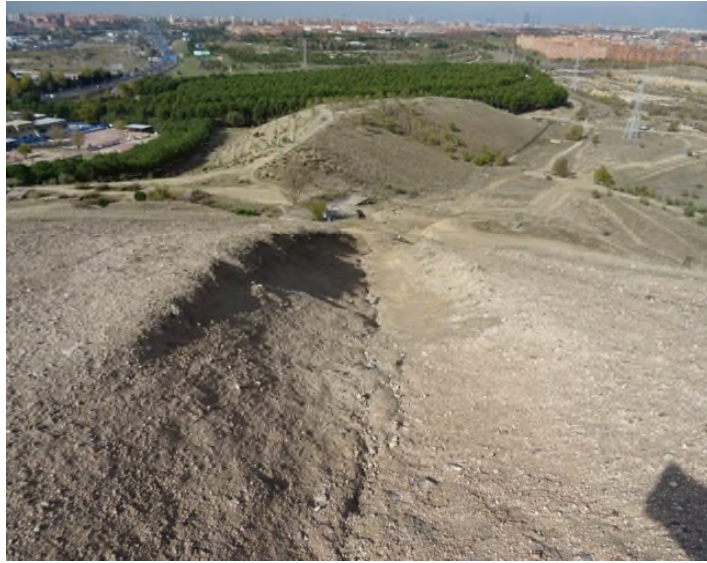
Vista desde la plataforma superior de la cabeza de la cárcava de C2. Se puede observar la escasa cubierta vegetal de esta zona.
