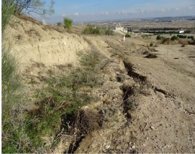
Incisión de la cárcava de C13 en el camino sur perimetral, junto al talud T3.
