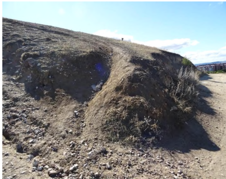
Vista lateral del talud T2 (a la derecha), en el que su principal problema es la erosión remontante y lateral que efectúa sobre la lineación erosiva C2.
