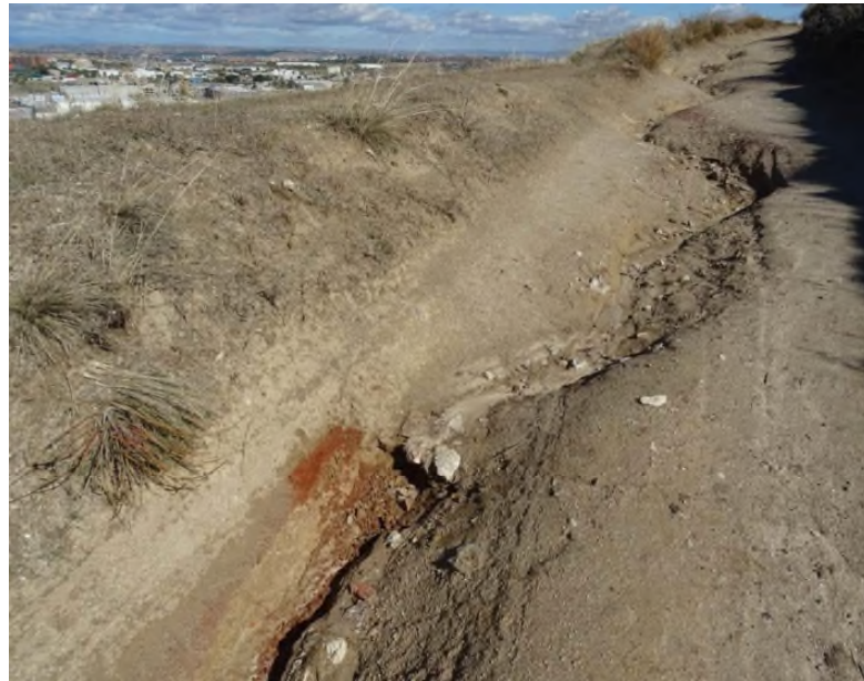
Detalle del mayor grado de incisión-erosión que presenta la cárcava de C5 en su tramo superior, donde además va disponiéndose onduladamente a lo ancho del camino, dificultando mucho su tránsito.
