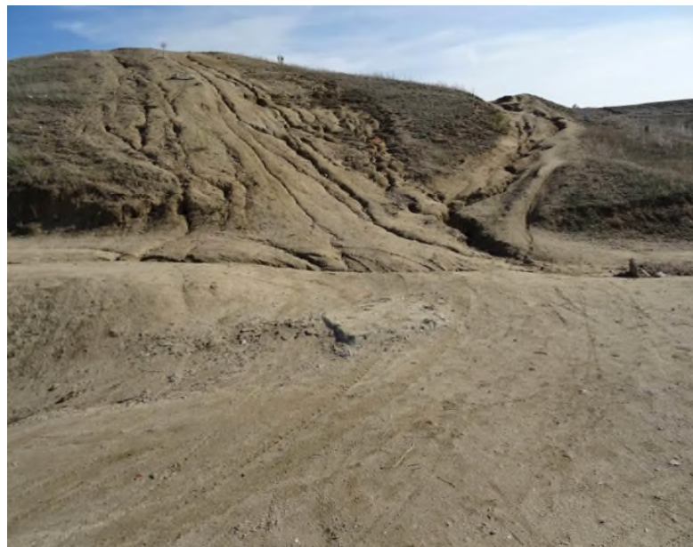
Una de las zonas más amplias que presentan un alto grado de erosión, son los regueros con amplia erosión laminar de la zona superior de la C7 (a la izquierda) y a la derecha de la foto la C3 con un elevado grado de incisión que genera varis cárcavas y regueros.
