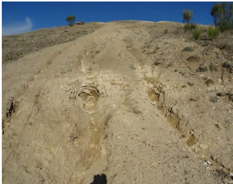
Vista de la mitad superior de la lineación erosiva C12. Se observa una erosión laminar muy ancha, la incisión tiene un grado medio generando regueros que pasan a cárcavas, pero la erosión en anchura es elevada.
