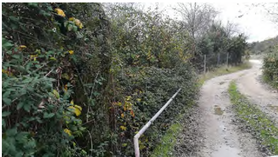
Figura 8.2.5.- Puente sobre al arroyo Puentedelgado. Cauce invadido por zarzas.
