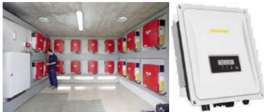
Imagen 6. Ejemplo de instalación de inversores distribuidos
