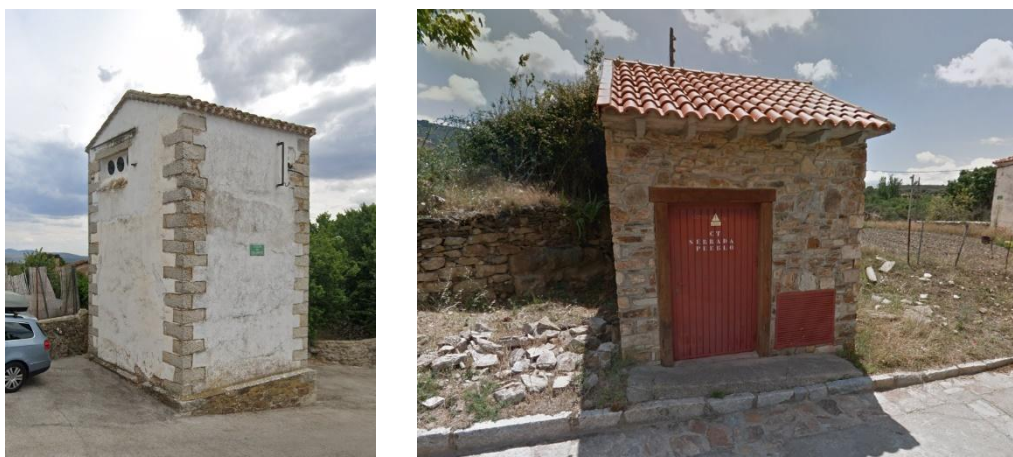
Figura 3. Centros de transformación eléctrica. Fuente: Google maps.
