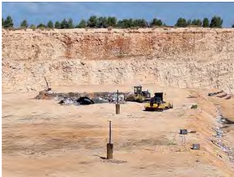
Estado actual del hueco donde se propone la ubicación del vertedero de residuos no peligrosos. Maquinaria y pozos verticales para evacuación del biogás.
