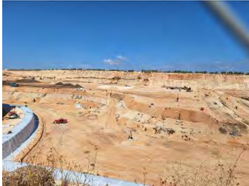
Estado actual del hueco donde se propone la ubicación del vertedero de residuos no peligrosos
