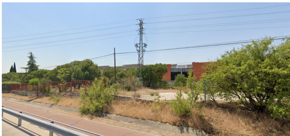
Imagen. vista parcial del tendido aéreo de la red de telefonía paralela a la antigua M-616
