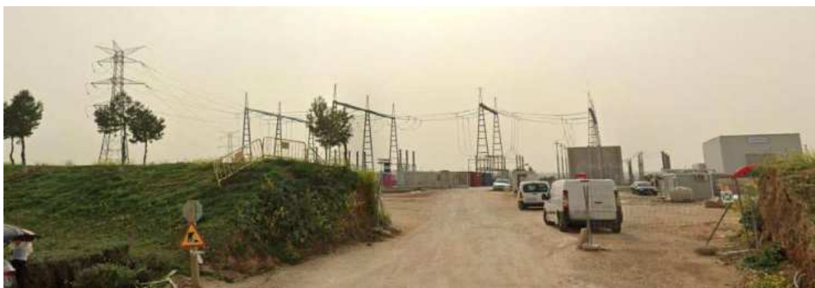
Figura 85. Subestación eléctrica de San Fernando
