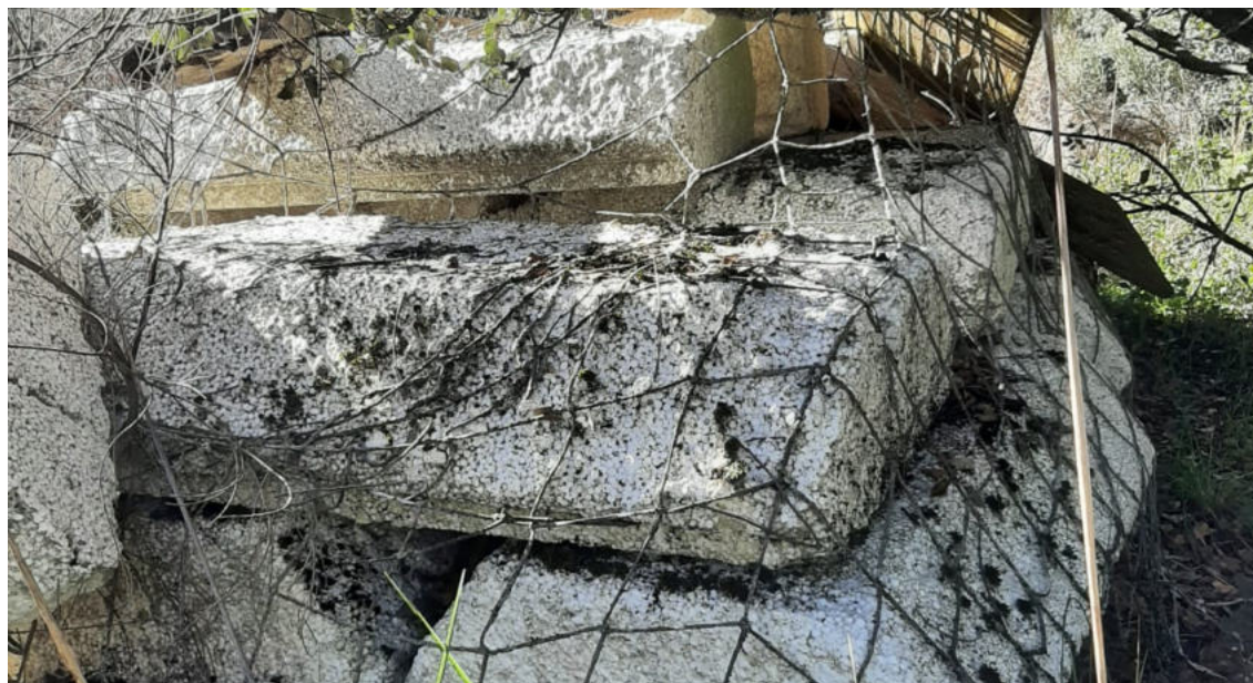
Figura 52. Escombros en el ámbito de estudio. Visita febrero 2024.
