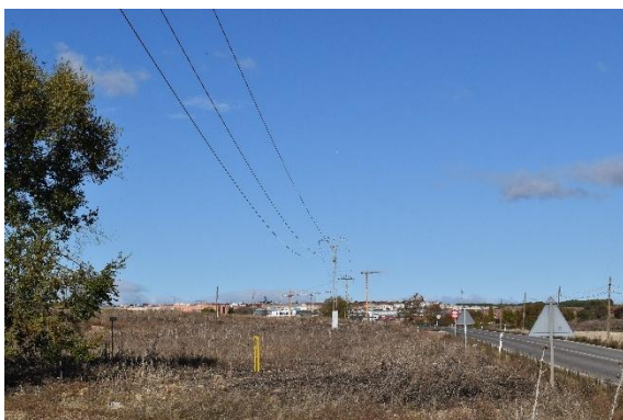
Línea eléctrica paralela a M-116 en zona norte
