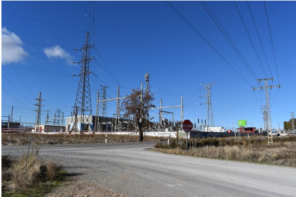
Subestación en la margen de la carretera M-116.
