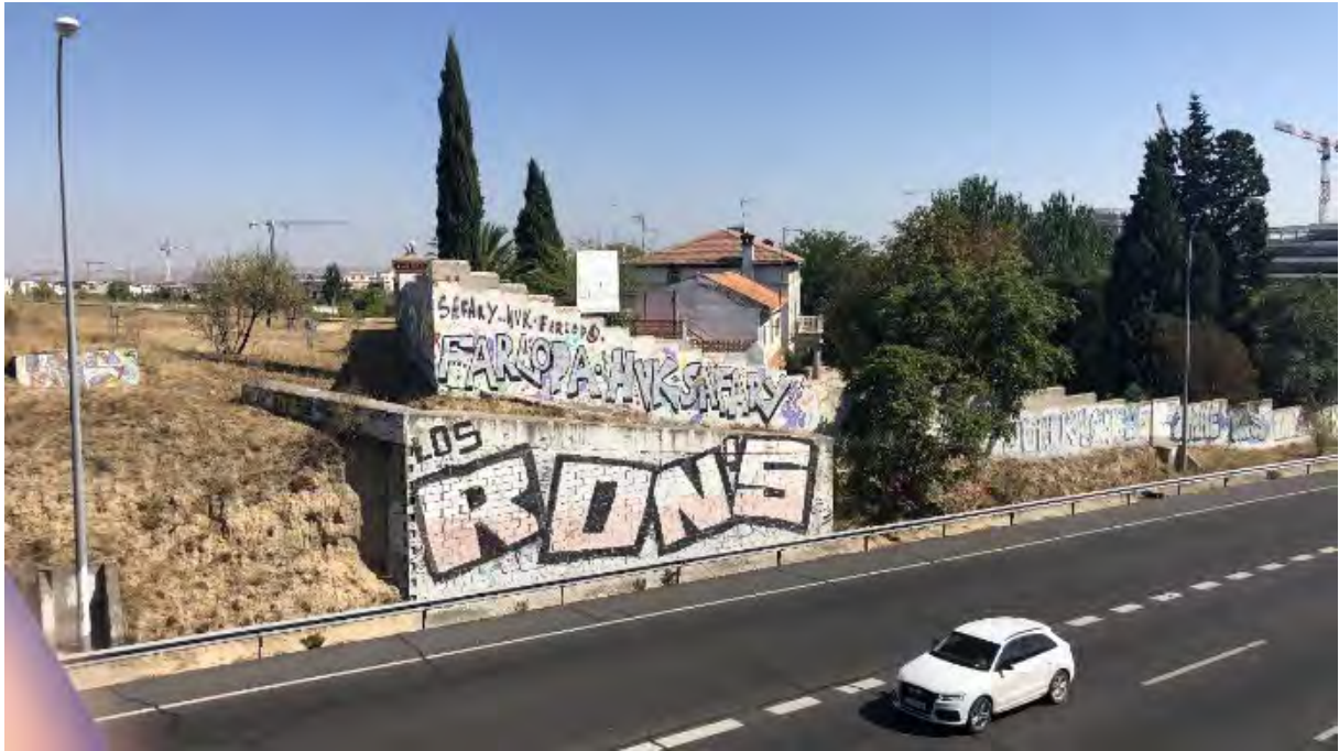
FOTO n° 3. Visión frontal del Muro que produce un estrangulamiento en la M40 por la antigua ejecución del carril de salida a la M-11 en el P.K. 3+000.
