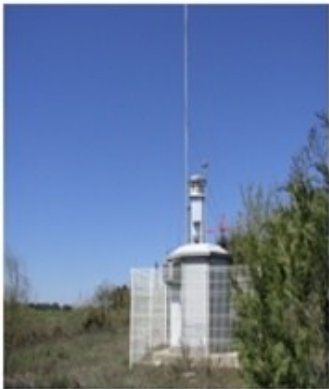
Figura 21. Características de la estación de Calidad del Aire Majadahonda.
