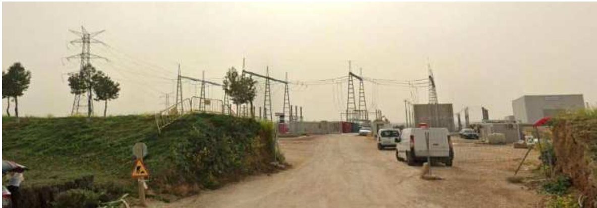
Figura 29. Subestación eléctrica de San Fernando
