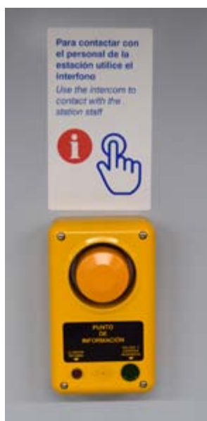
Interfono de estación
