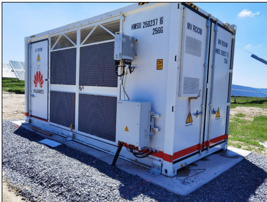
Imagen 9. Centro de Transformación tipo.
