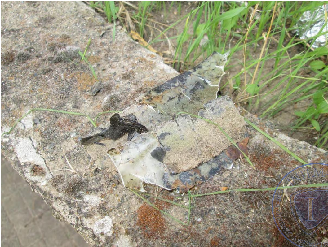
Fotografía nº 24: fragmento del sistema de impermeabilización de las jardineras, desprendido con la mano.
