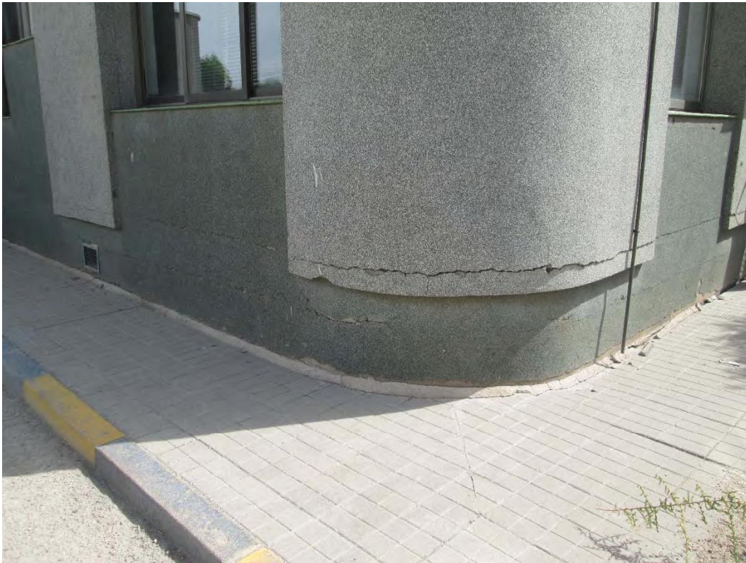
Fotografía nº 1: fisuras horizontales en la parte inferior del cerramiento de fachada.
