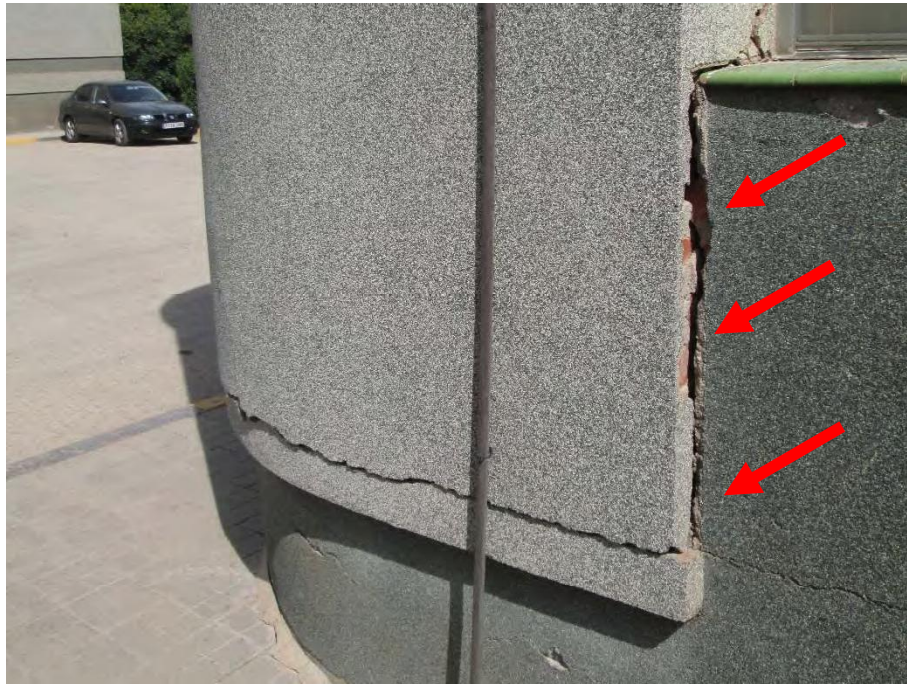
Fotografía n° 9: fisura vertical en el encuentro entre dos paños de fachada.
