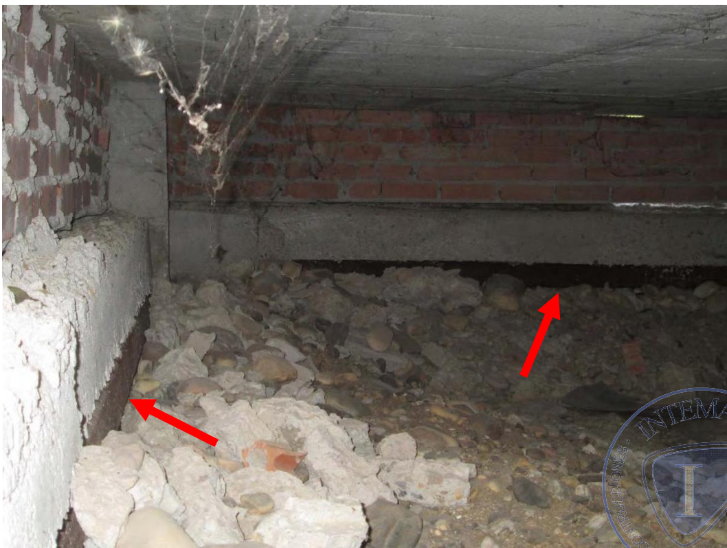
Fotografía n° 22: cámara de aire bajo el forjado, perfiles metálicos de apoyo de la solera de hormigón de la acera.
