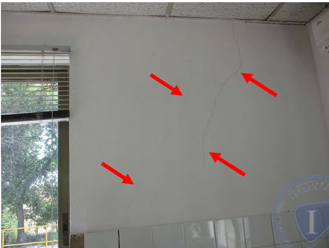
Fotografía n° 18: fisuras inclinadas en la hoja interior del cerramiento.
