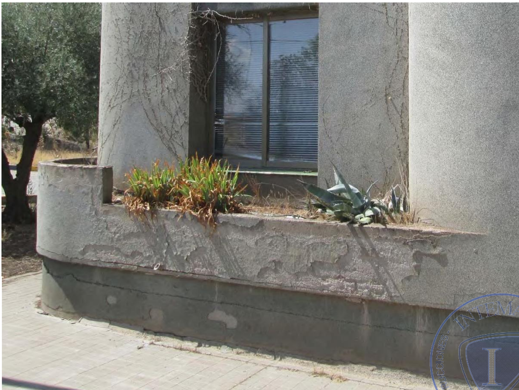
Fotografía n° 14: deterioro del revestimiento exterior del cerramiento en las jardineras.
