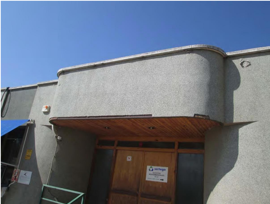
Fotografía n° 15: desprendimiento del revestimiento exterior en el voladizo sobre la entrada principal.
