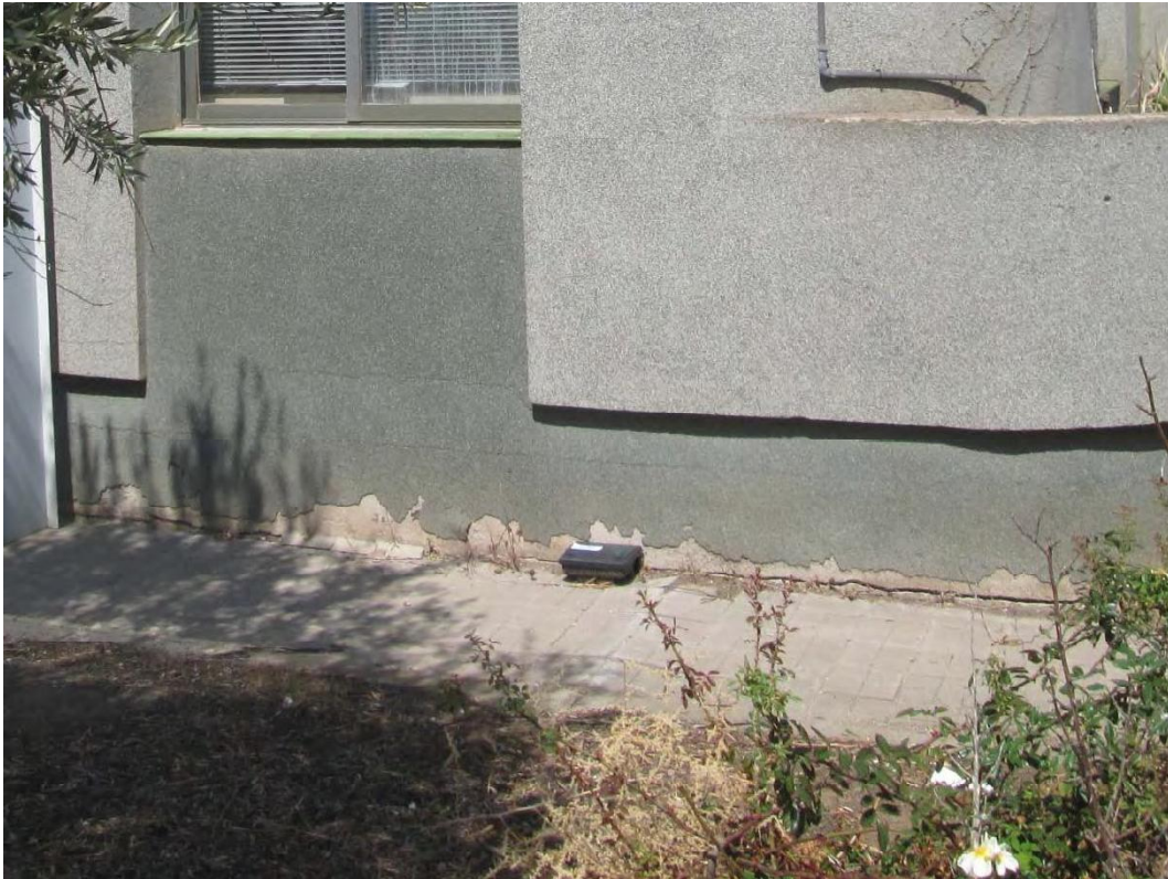
Fotografía n° 5: fisura horizontal en el encuentro del cerramiento con la acera.
