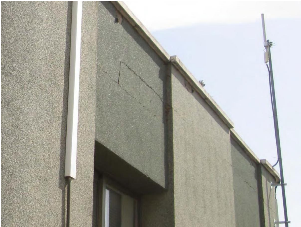
Fotografía n° 3: fisuras horizontales (y alguna vertical) en la parte superior del cerramiento.
