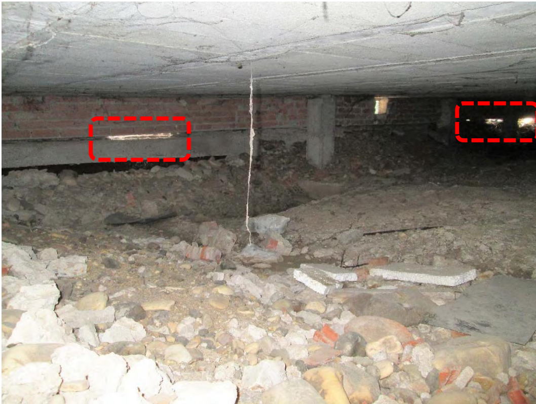
Fotografía n° 21: cámara de aire bajo el forjado, fisuras pasantes en el encuentro con la hoja exterior del cerramiento.
