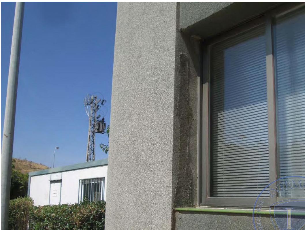
Fotografía nº 8: fisura vertical en la jamba de una ventana, reparada.
