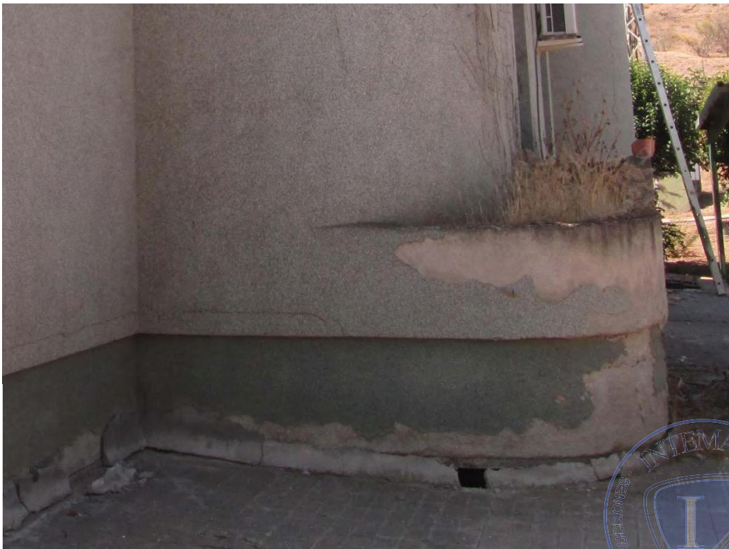
Fotografía n° 6: fisura horizontal en el encuentro del cerramiento con la acera, con signos de reparaciones previas.
