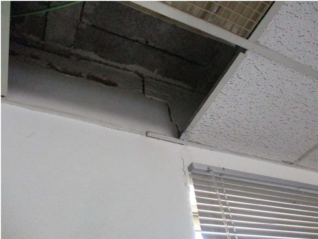
Fotografía n° 17: fisura inclinada y horizontal en el encuentro con el forjado superior, hoja interior del cerramiento.
