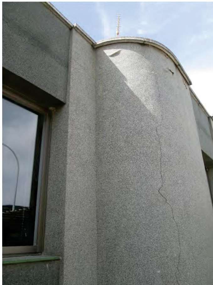
Fotografía n° 10: fisura vertical en una esquina curva, afectando a toda la altura del cerramiento.
