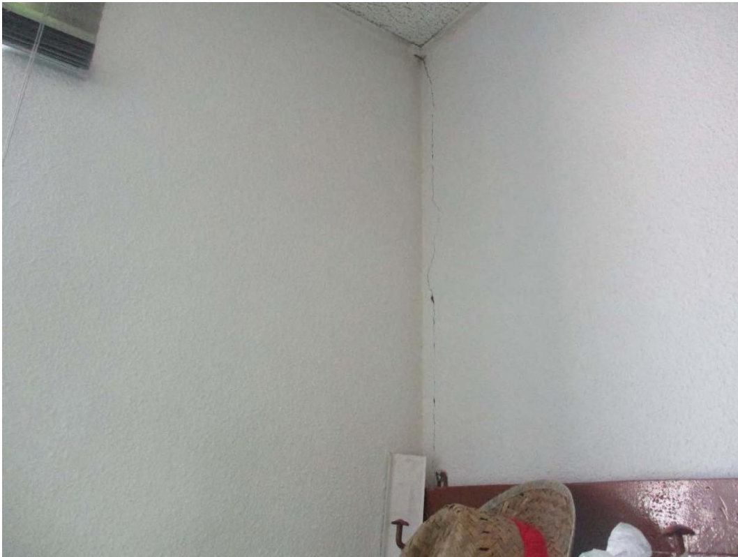
Fotografía n° 19: fisura vertical en un rincón de la hoja interior del cerramiento.
