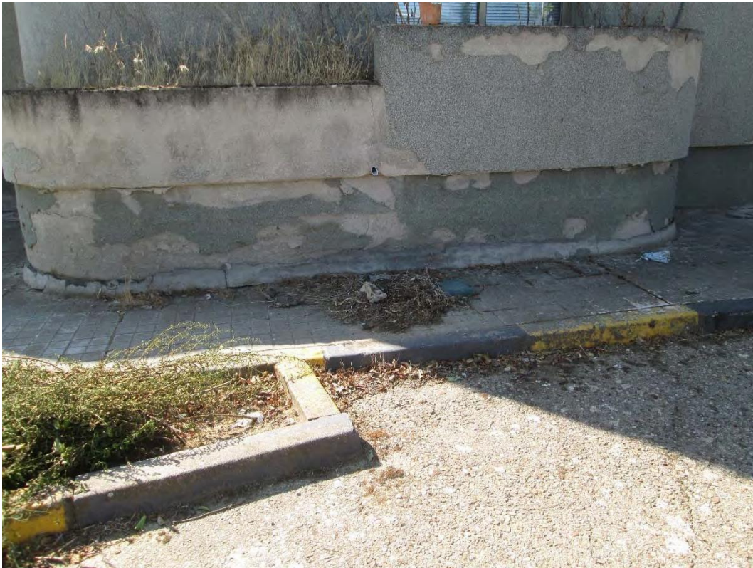
Fotografía n° 13: deterioro del revestimiento exterior del cerramiento en las jardineras.
