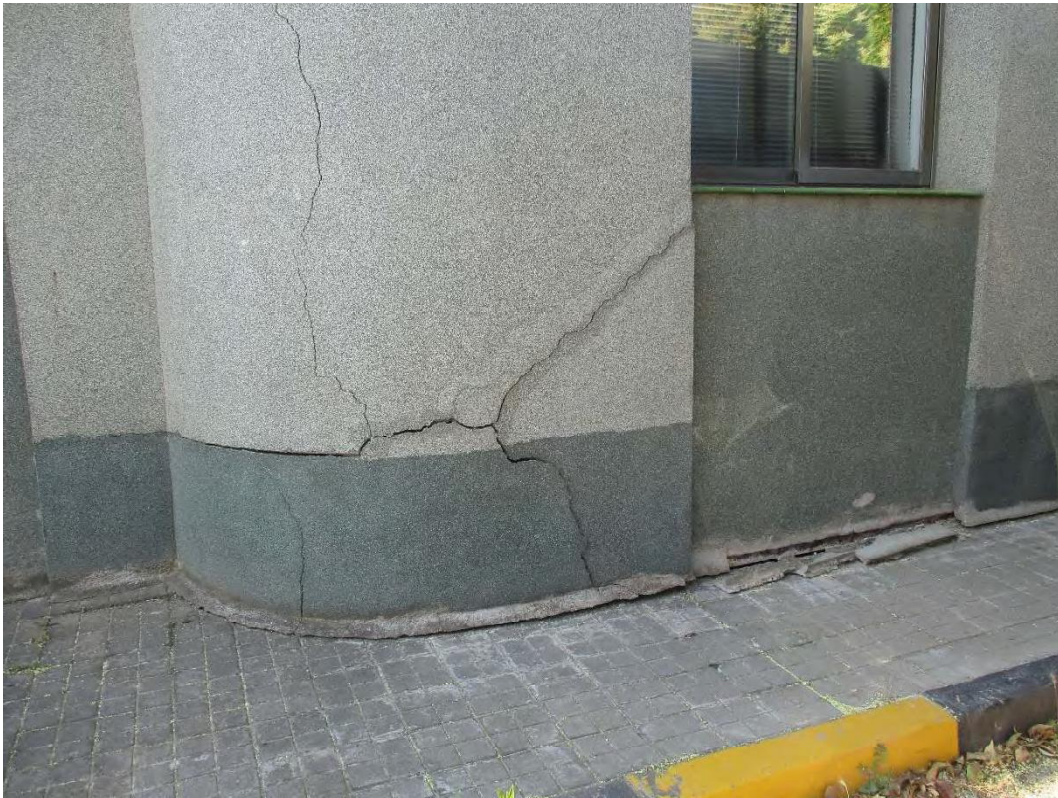
Fotografía nº 11: fisuras de diverso tipo en una esquina curva del cerramiento.
