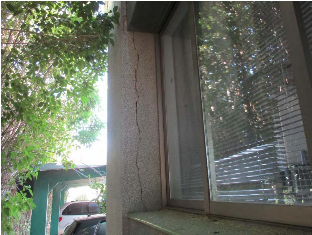
Fotografía nº 7: fisura vertical en la jamba de una ventana.
