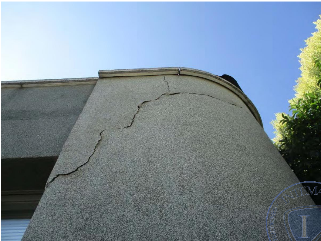
Fotografía nº 12: fisura inclinada y ascendente.
