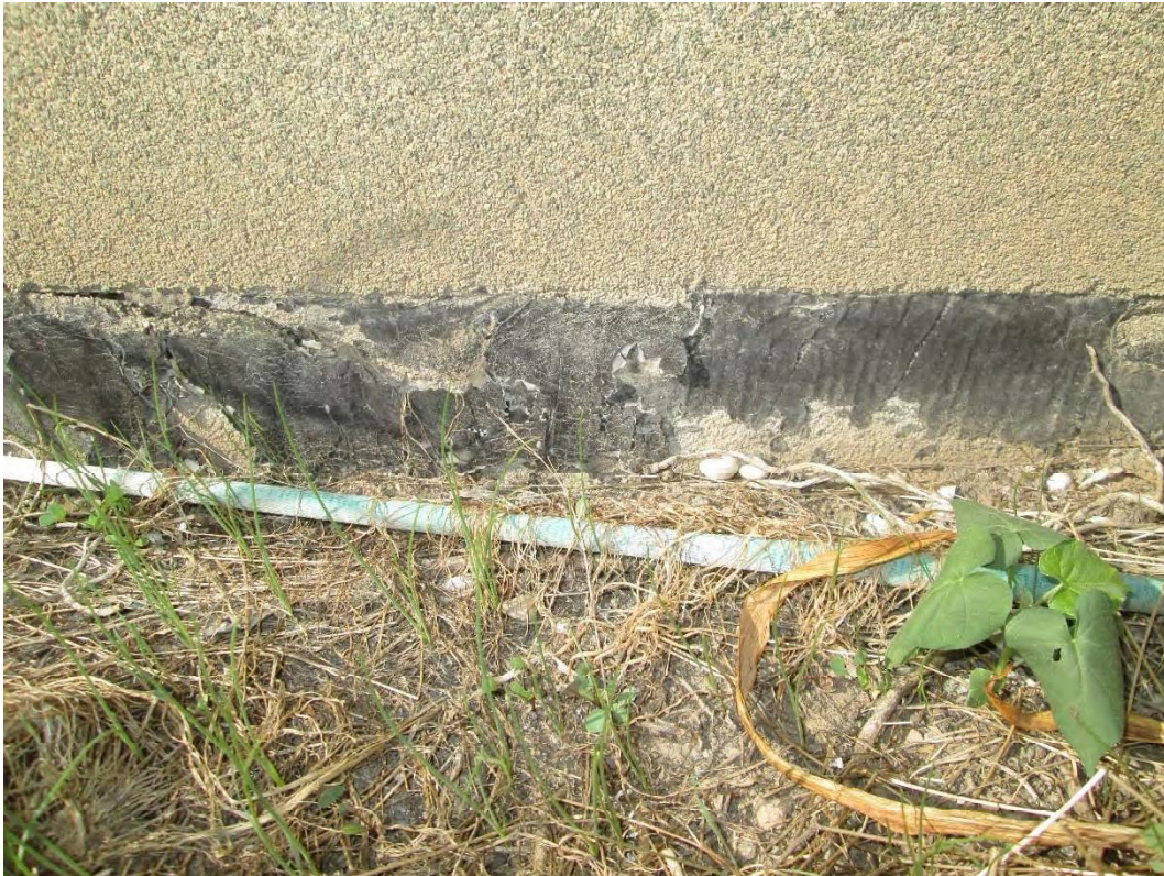
Fotografía nº 23: sistema de impermeabilización del interior de las jardineras, parcialmente al descubierto, fisurado y despegado.
