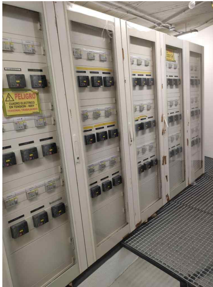
Imagen 1. Cuadro general de mando y protección.
