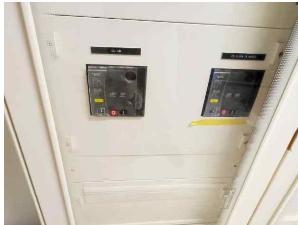
Imagen 2. Protecciones dotadas de cabeza motorizada.
