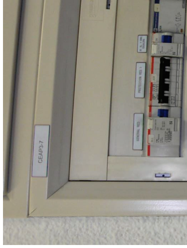
Figura 14 - Etiquetado de cuadro eléctrico con parte fija exterior en el frontal
