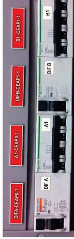
Figura 22 - Etiketado de Protecciones de Cuadro en Servicio SAI
