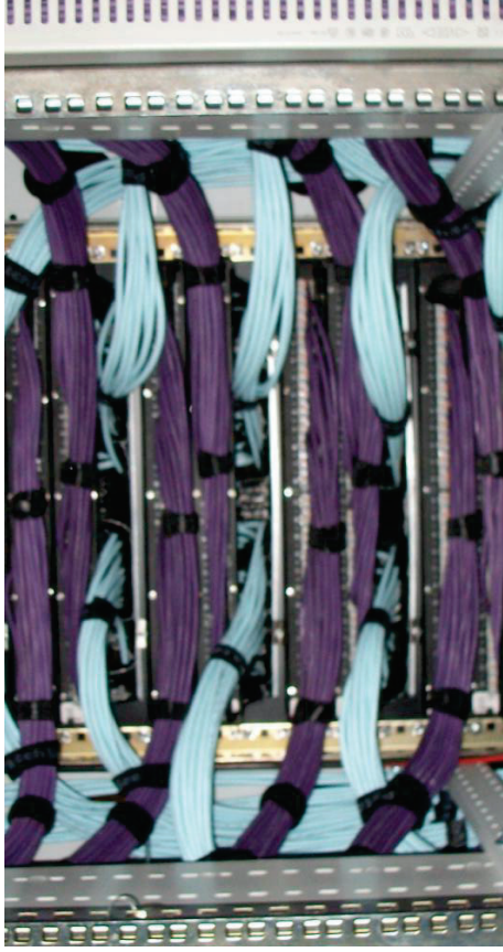
Figura 43- Encaminado vertical de los latiguillos por los laterales del interior del armario
