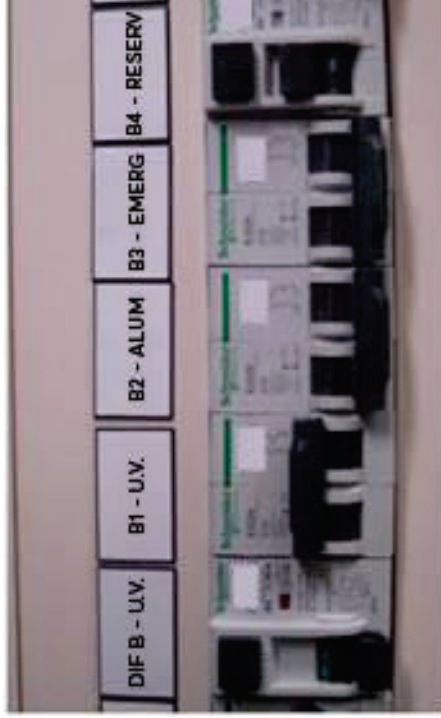
Figura 19 - Etiquetado con placas serigrafadas autoadhesivas de Protecciones en Servicio No SAI
