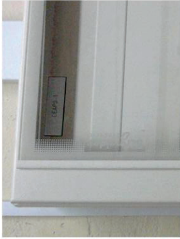
Figura 15 - Etiquetado de cuadro eléctrico sin parte fija exterior en el frontal y puerta transparente.
