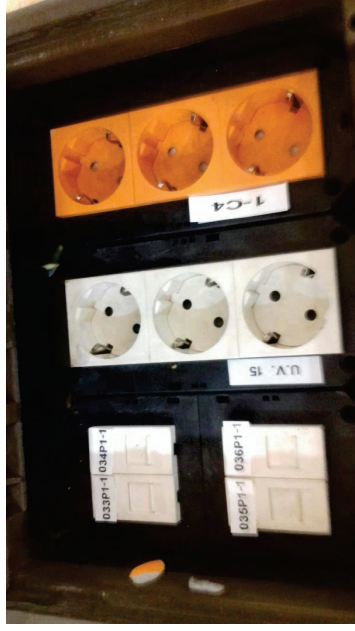
Figura 11 - Etiquetado de punto de conexión de la red multiservicio
