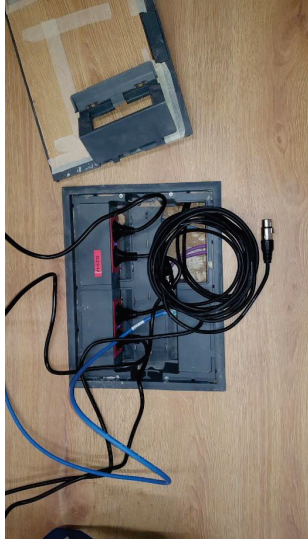
Figura 11 – Cableado de micrófono en sala de vistas
