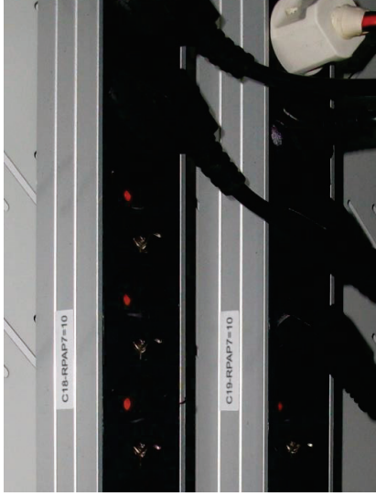
Figura 26 - Etiquetado de Regletas Eléctricas en su Cara Superior
