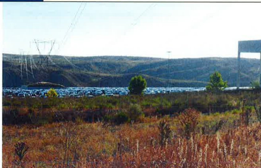
Línea eléctrica de Alta Tensión
