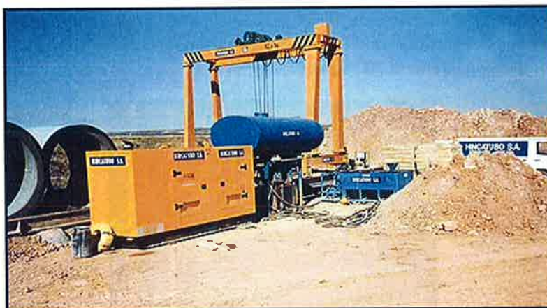
Figura 5.- Generador de corriente auxiliar para dotar de energía eléctrica al sistema
