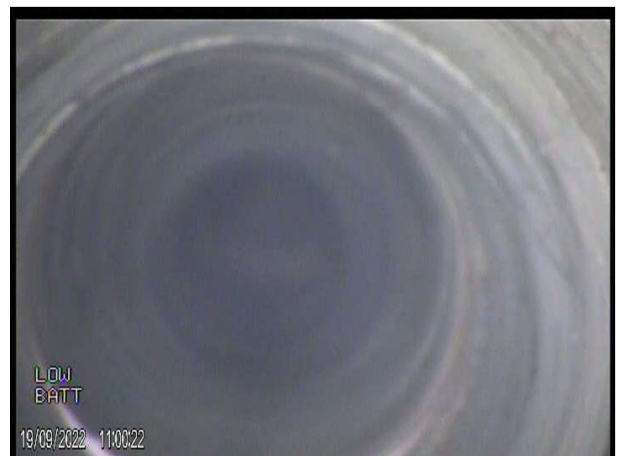
Foto: 8_2B, MPEG #: 190922_1, 00:00:00 68,41m, Nudo de final, registro, P.55QJ-428
