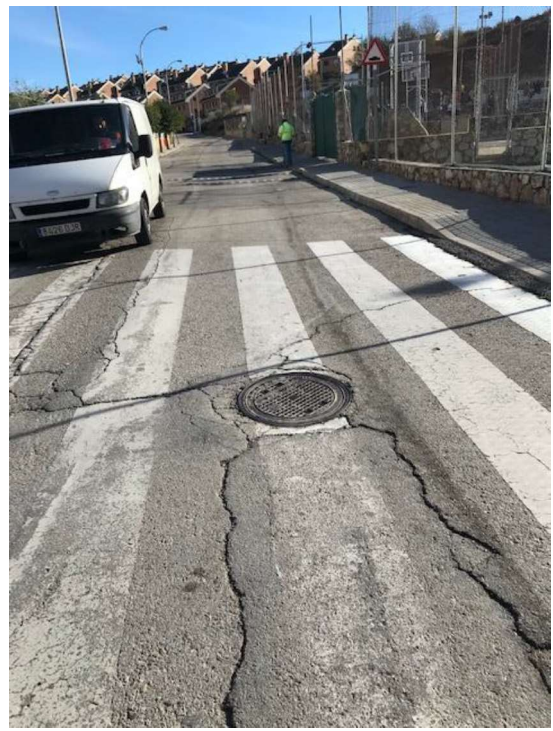
Pozo P.55QJ-428. Pº de Pozuelo
