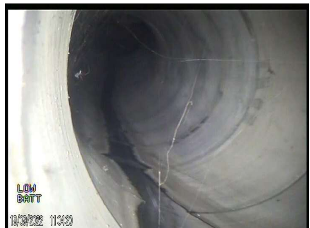
Foto: 9_2B, MPEG #: 190922_1, 00:00:00 50,8m, Nudo de final, registro, P.55QJ-438
