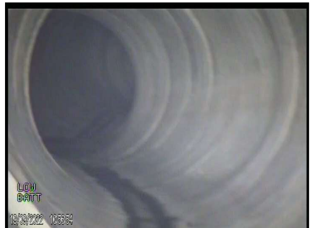
Foto: 7_2B, MPEG #: 190922_1, 00:00:00 102,3m, Nudo de final, registro, P.55QJ-627
