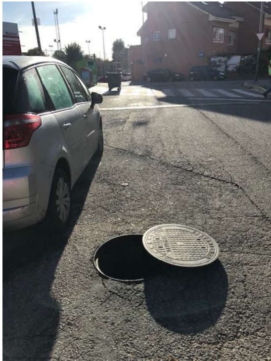
Pozo P.55QJ-438. C/ Ámsterdam vista hacia Pº de Pozuelo
