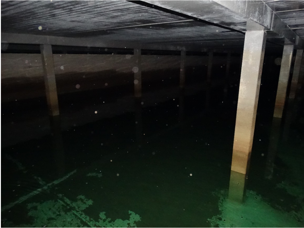
Figura 4-3 Estado actual Estructura Deposito El Pinar
