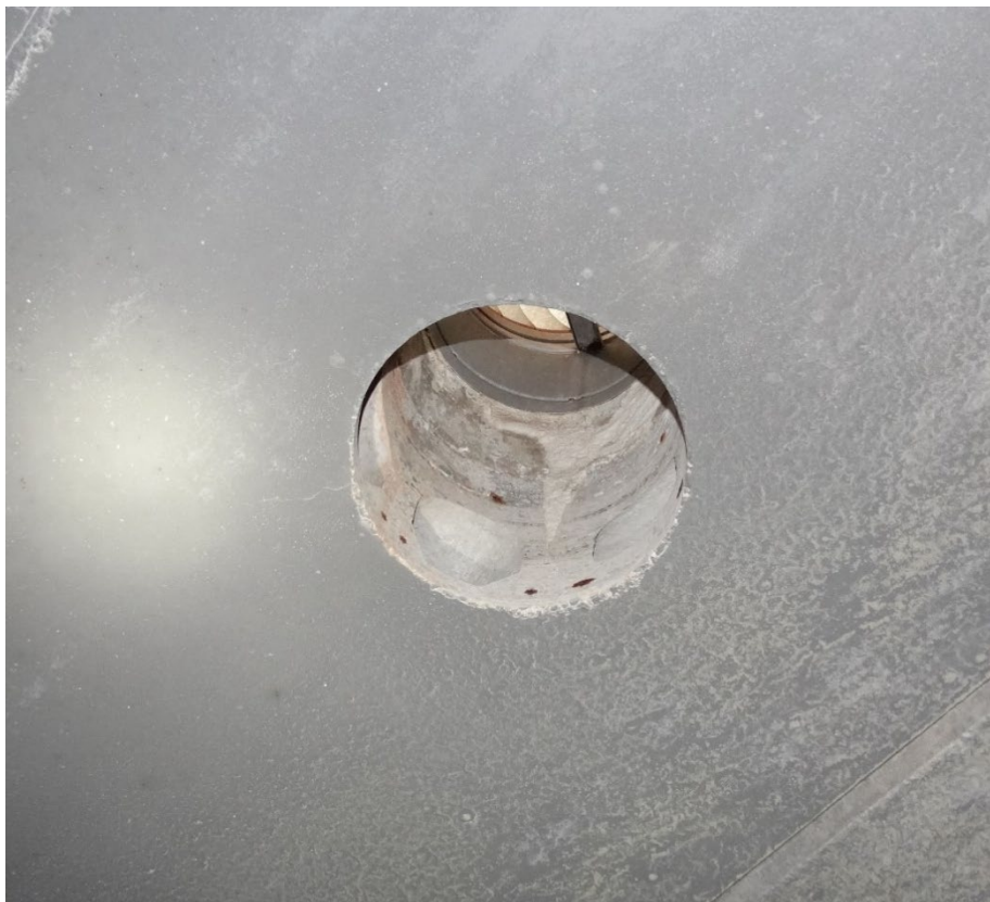
Figura 4-5 Taladro Respiradero en forjado Cubierta Estructura Deposito El Pinar
