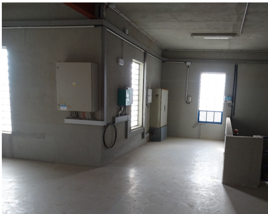
Figura 9. Cuadro de distribución existente en la caseta de válvulas.
