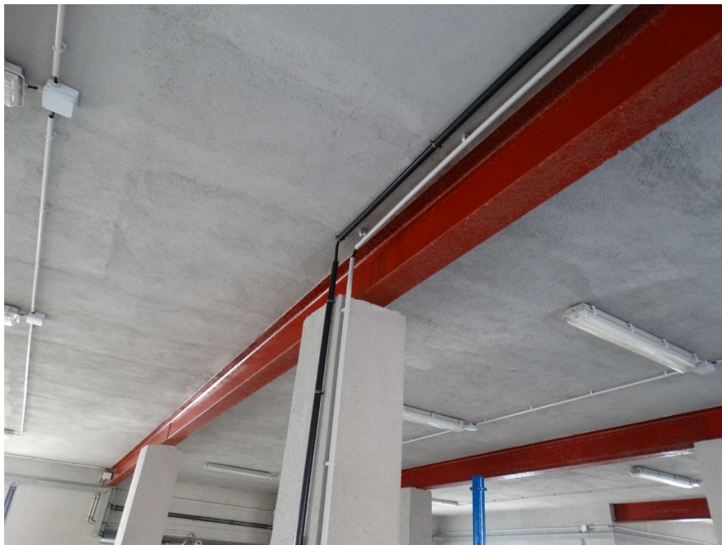
Figura 4-2 Estado actual Estructura metálica caseta válvulas Deposito El Pinar
