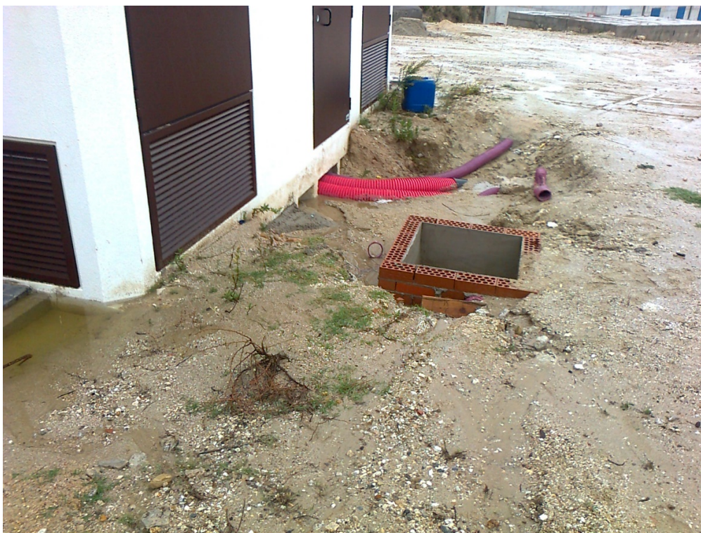
Imagen 5-8. Entrada de zanja en la Estación Elevadora Nuevo Tres Cantos. Arqueta de final de zanja.
