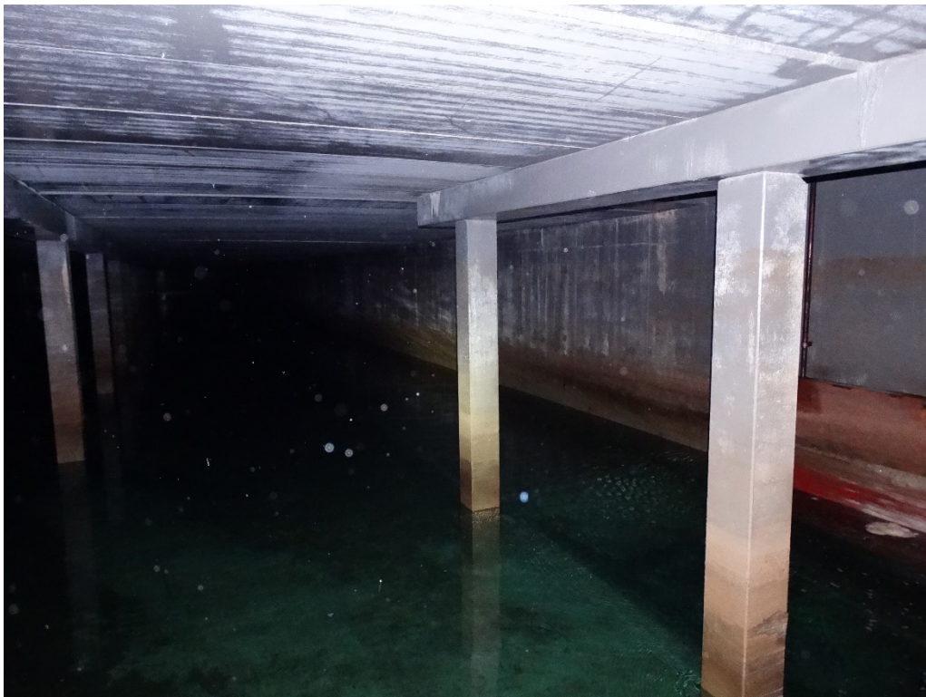
Figura 4-4 Estado actual Estructura Deposito El Pinar
