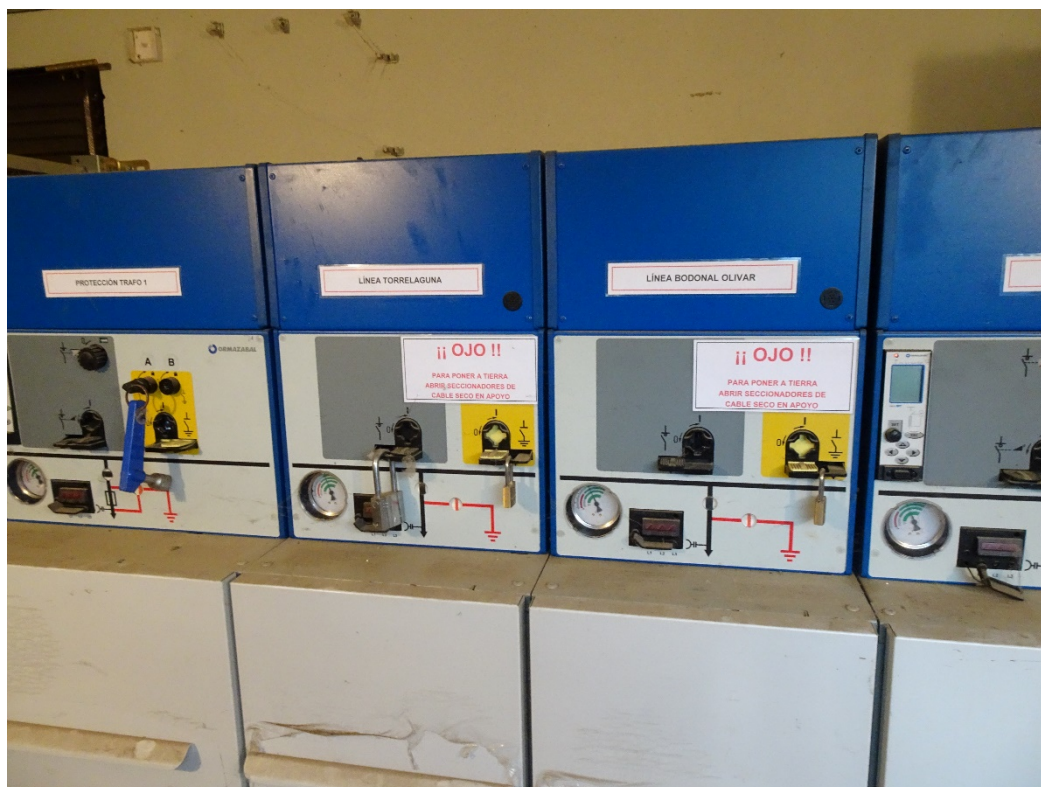
Imagen 5-9. Celdas de entrada y salida de línea de CT Nuevo Tres Cantos.
