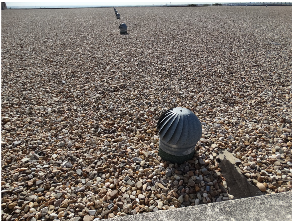
Imagen 2-5. Vista de la cubierta. Se observa la hilera de respiraderos del depósito. Imagen realizada desde el muro NO de la Planta 1.
