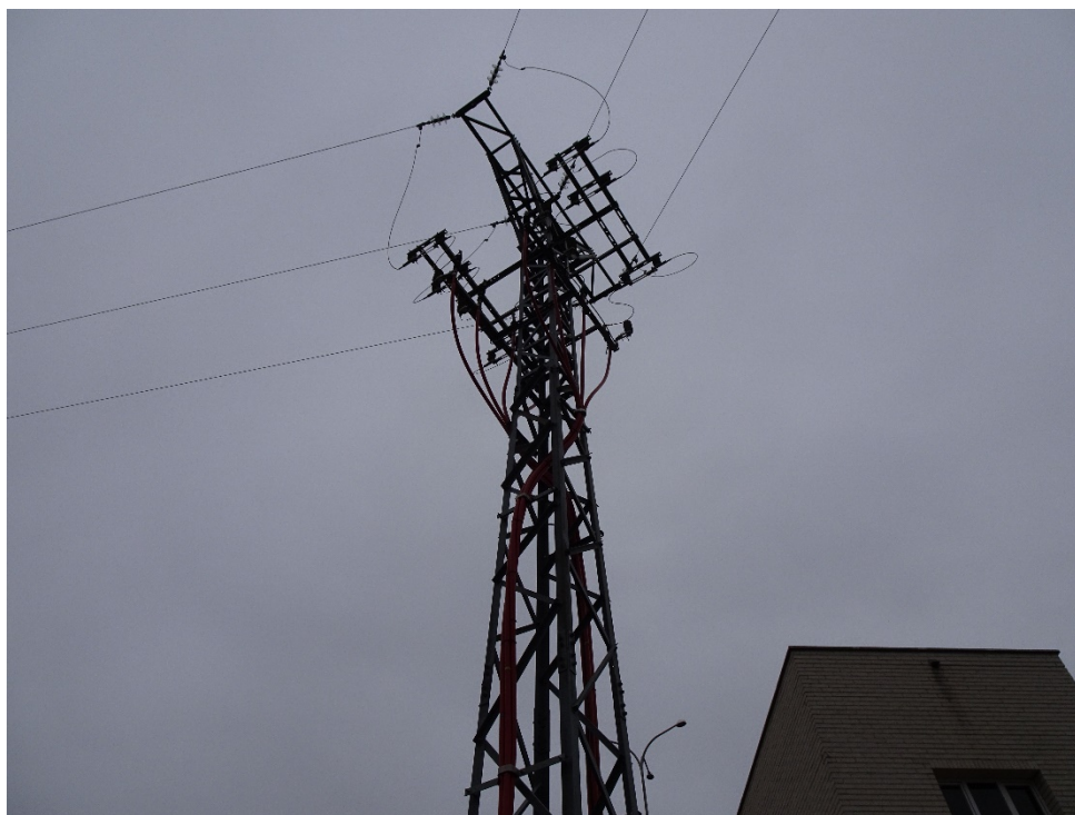
Imagen 5-4. Vista del apoyo con las dos derivaciones para hacer anillo con el CT de Nuevo Tres Cantos.
