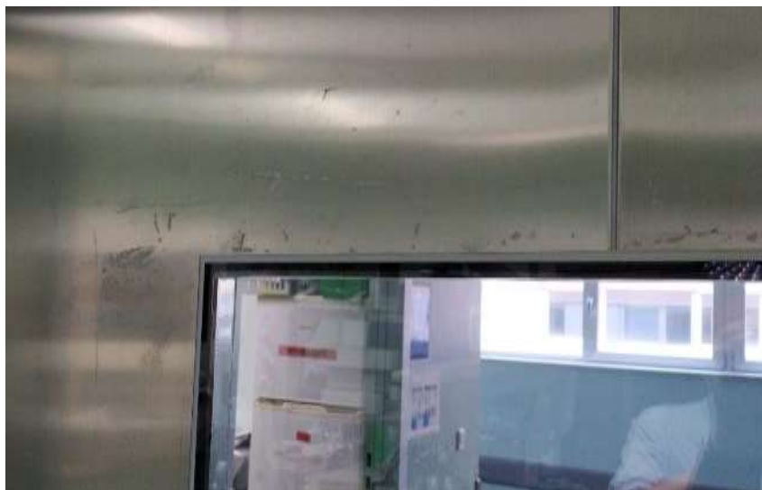
ÁREA MUY CRÍTICA
