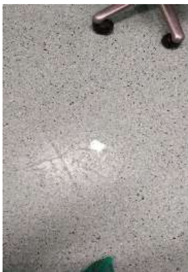
ÁREA MUY CRÍTICA
