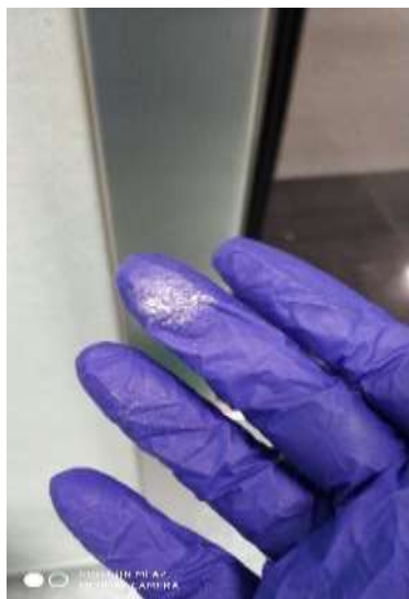
ÁREA MUY CRÍTICA
