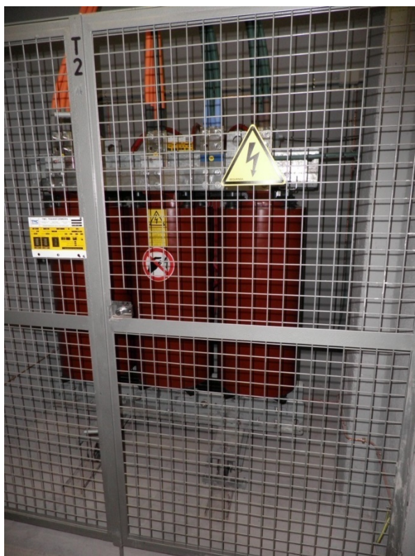
Transformador seco de 1.600 kVA
