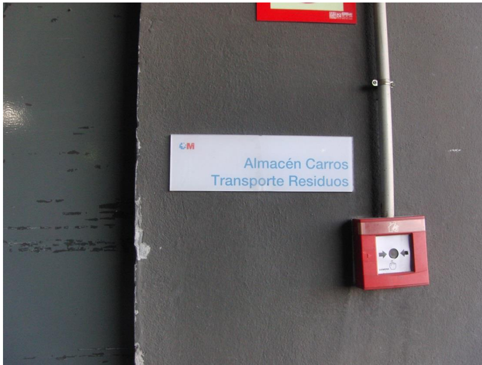
Foto 3: Incidencia observada en almacén de residuos. Ver Ítems 36,40,48 y 56
