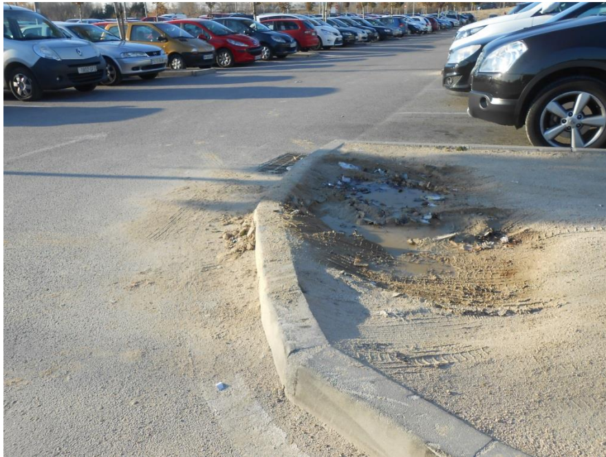
Foto 5: Incidencia en zona de aparcamiento (I). Ver Ítems 11 y 50
