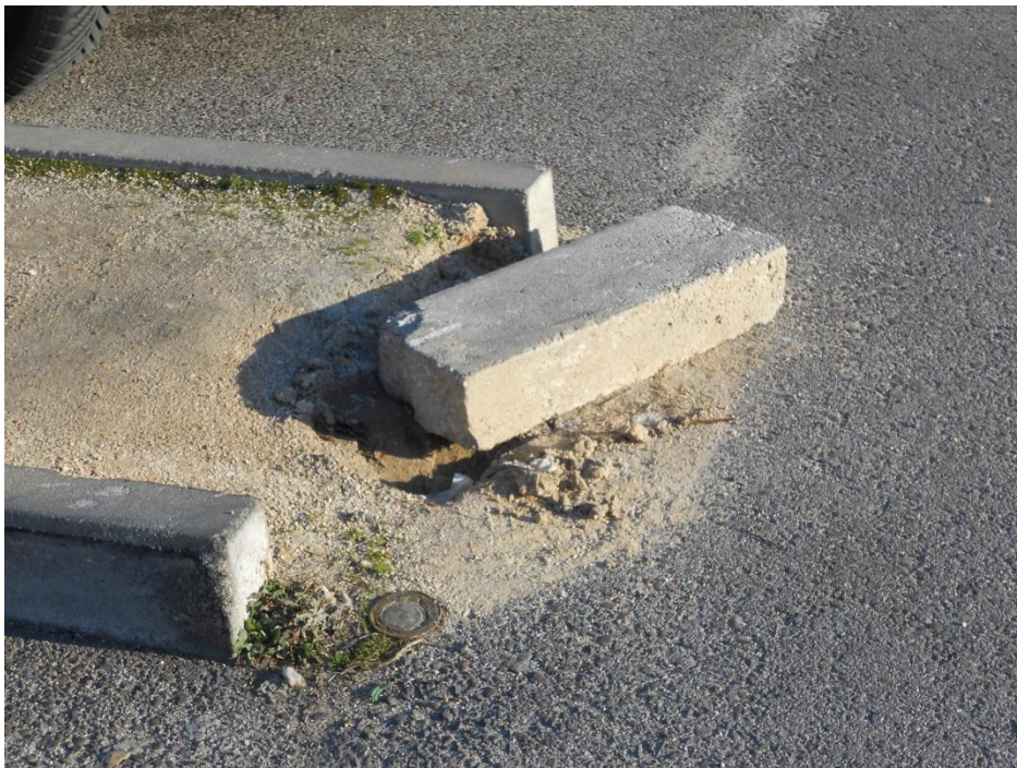
Foto 6: Bordillo roto. Ver Ítems 11 y 50
