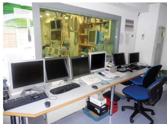
Control de la sala
