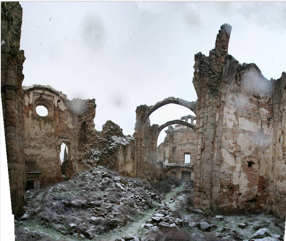
Fotografía actual desde el mismo punto de vista con el escombros del colapso de arcos, muros y bóvedas
