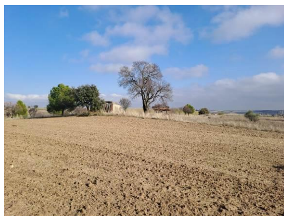
Foto 54. LE soterrada entre Camino del Molino y final de la línea.
