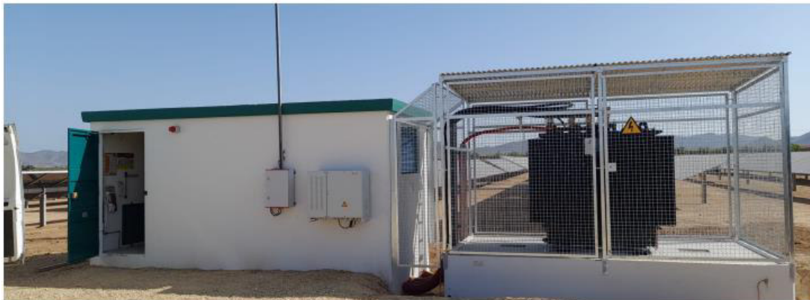
Figura 5.- Centro de transformación híbrido
