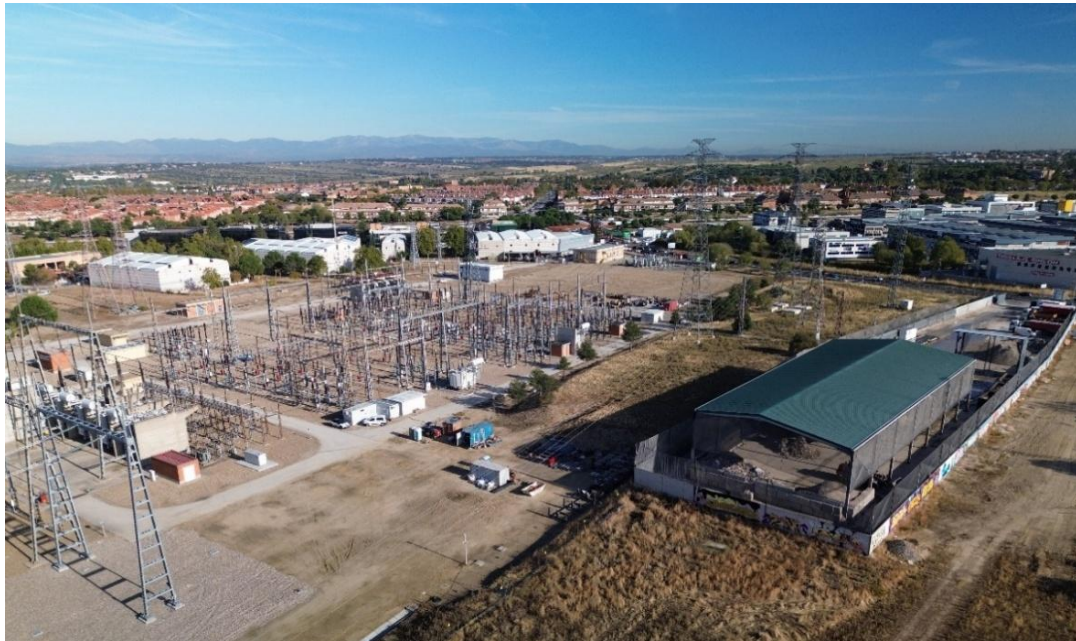
Figura 58. SET Villaviciosa (REE) y vegetación colindante. Fotografía tomada por dron el día 28 de octubre de 2025.
