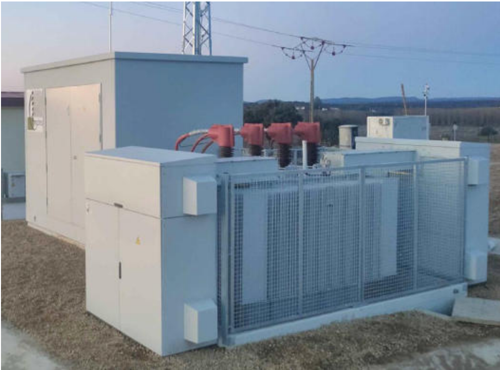
Imagen 5 Detalle de estación transformadora
