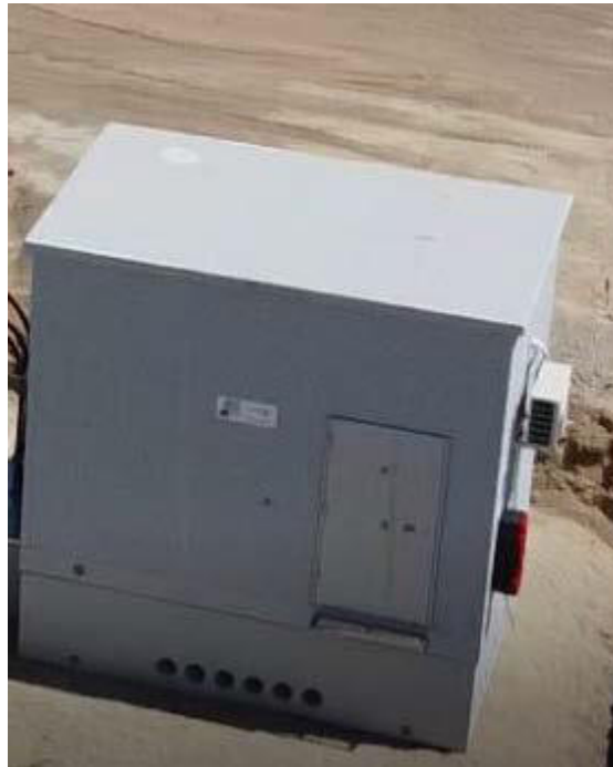
Imagen 6 Detalle de Centro de Seccionamiento
