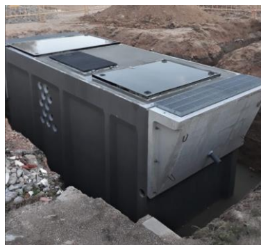
Imagen 11. Centro de seccionamiento tipo
